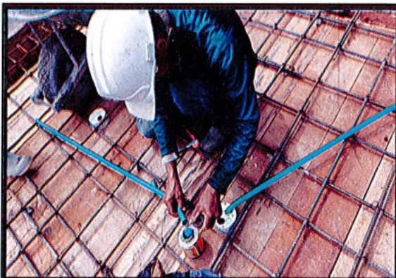
SALIDA INTERRUPTOR TRIPLE EN TUBERÍA CONDUIT PVC DE 1/2", ALAMBRE N°12 AWG.
