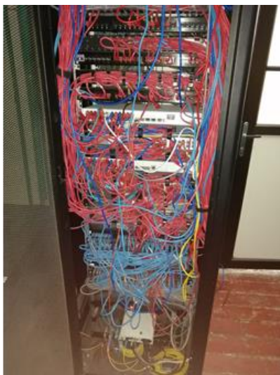
Rack Edificio Viejo
