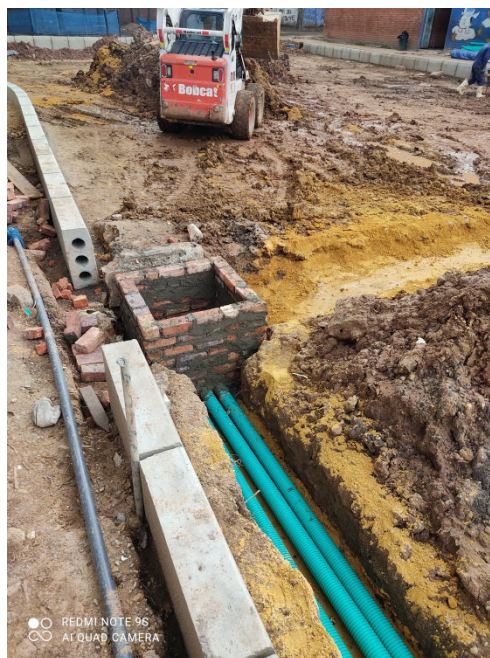
TUBERIA TDP CANALIZACIÓN ELECTRICA 3X3 7X1/0+ 1 Antifraude
