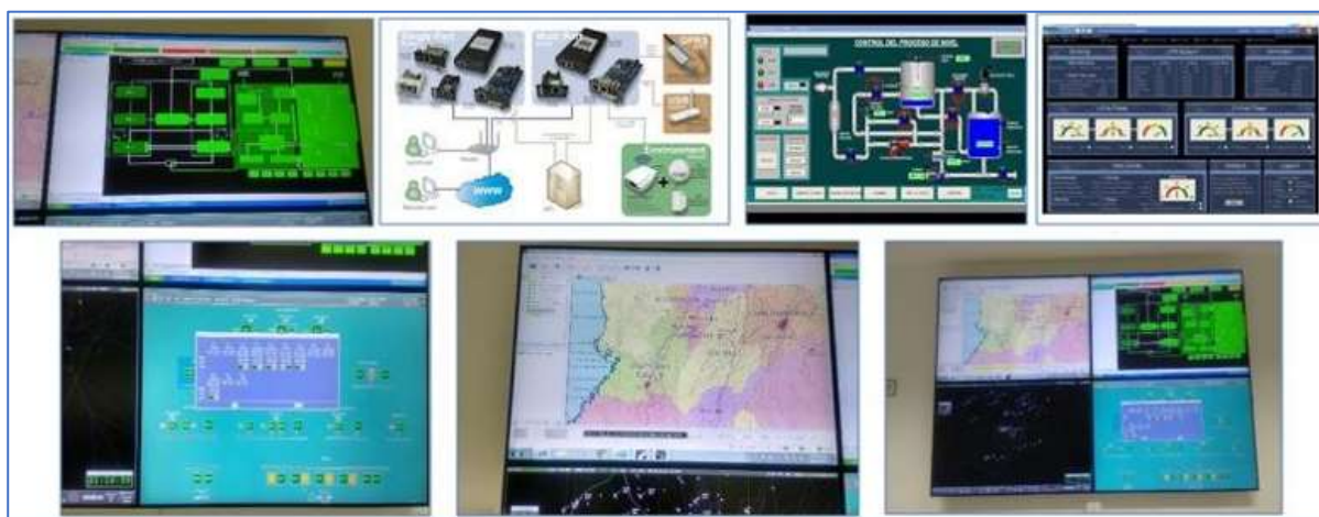
Sistemas de monitoreo CNS Aeropuertos regional Valle.
