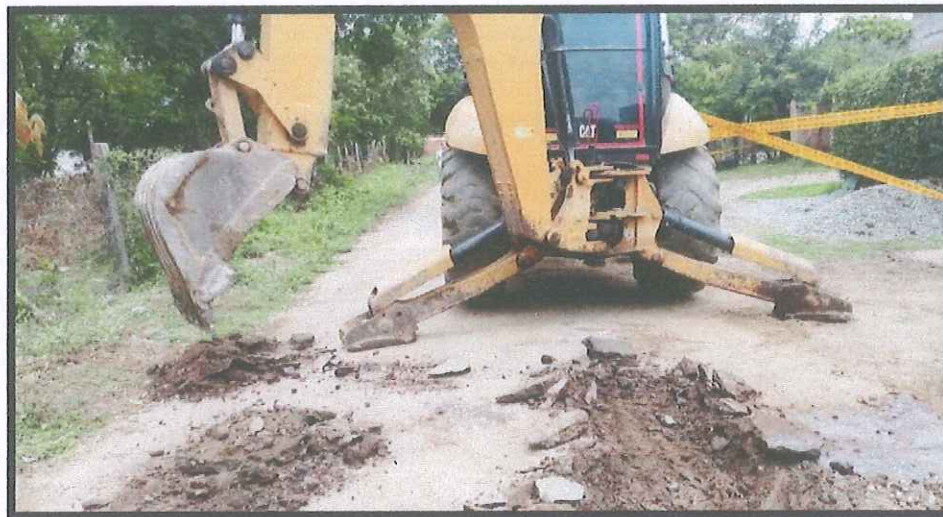
Ilustración 11: Rotura de pavimento Pozo 31 al 29 Fuente: Propia
