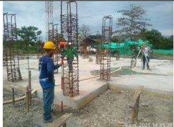
Foto 02: Lleno estructural en la estructura 5.
