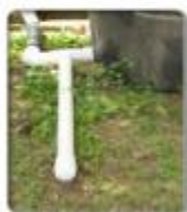
Figura 30. Dispositivo de entrada al reactor metanogénico.
