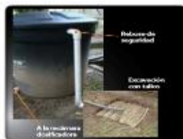
Figura 23. Tuberías de salida del reactor hidrolítico.
