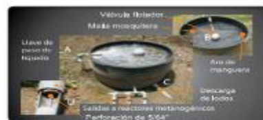
Figura 25. Conexiones en la cámara dosificadora.
