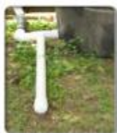
Figura 30. Dispositivo de entrada al reactor metanogénico.
