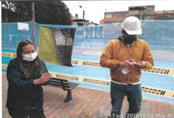
Foto No. 63. Se revisó y verificó el cumplimiento del plan de manejo de tránsito (PMT), parque. URBANIZACIÓN LA ESTANCIA. 19-149 el cual no se cumple.
