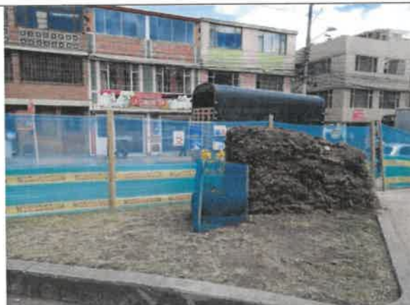
Foto No. 79. Se revisó y verificó el acopio de material de cespedón para disposición final sin el respectivo cerramiento y señalización, parque, URBANIZACIÓN LA ESTANCIA. 19-038
