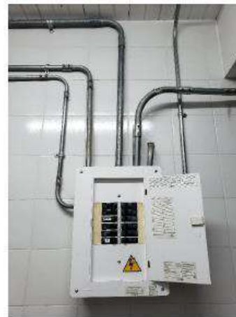
Ilustración 117 Tablero de distribución secundario bloque 66
