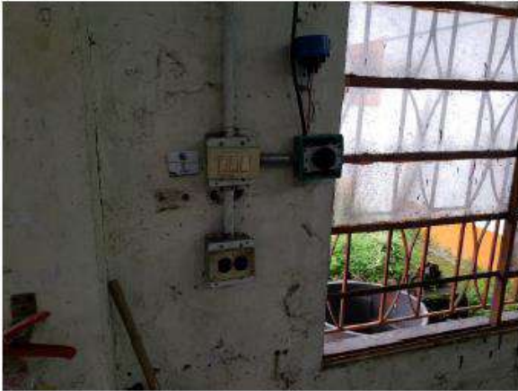
Ilustración 101 Tomacorrientes sin tapas, canalización PVC.
