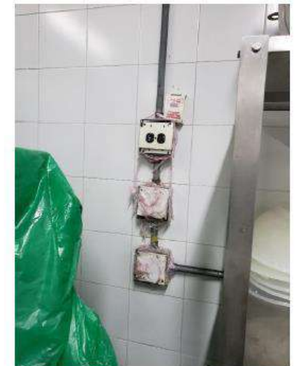
Ilustración 48 Tomacorrientes cocina bloque 16
