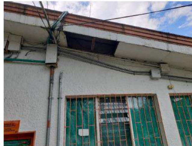
Ilustración 26 Ingreso acometida principal bloque 16
