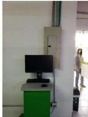
Ilustración 14 Tablero eléctrico Biblioteca bloque 16
