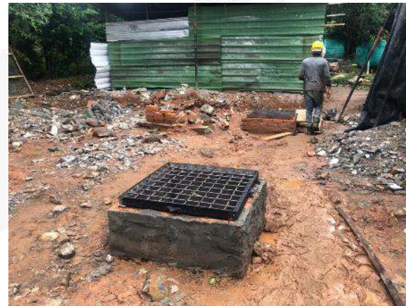
Tapas cajas sanitarias
