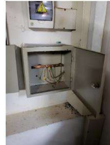
Ilustración 119 Gabinete de tierras sistema regulado bloque 66
