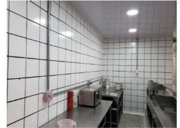
Ilustración 47 Tomacorrientes cocina bloque 16
