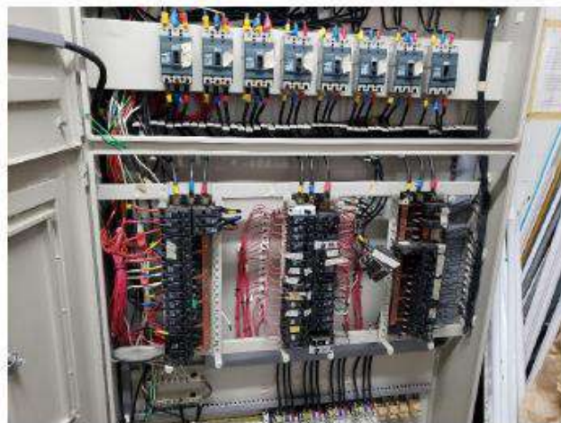
Ilustración 12 Brakers de distribución a tableros bloque 16
