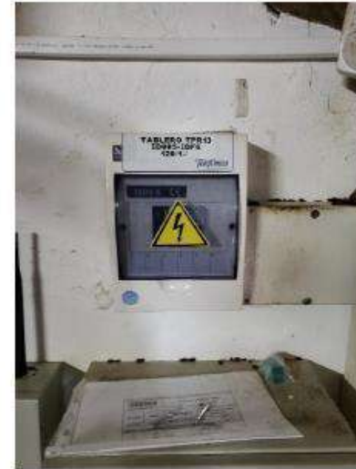
Ilustración 118 Tablero regulado piso 2 bloque 66
