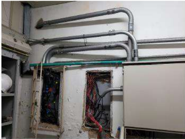
Ilustración 11 Acometida principal tablero bloque 16
