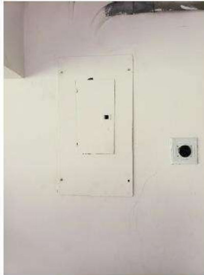
Ilustración 116 Tablero de distribución normal piso 2 bloque 66
