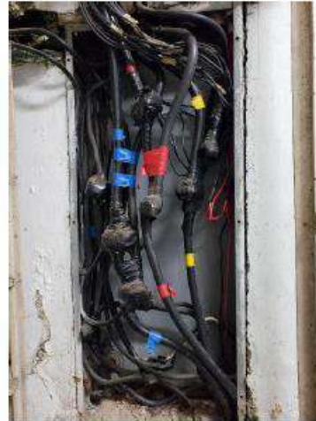
Ilustración 13 Empalme acometida principal bloque 16
