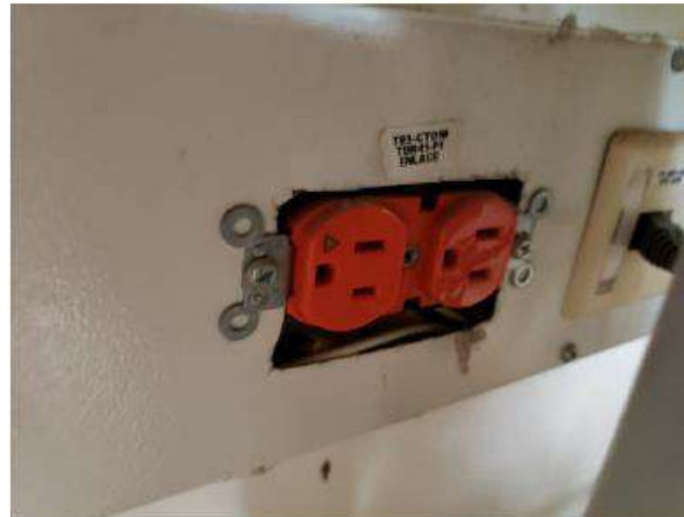
Ilustración 104 Tomacorriente regulado bloque 42
