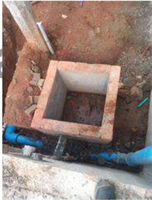
Caja eléctrica y tuberías incendios
