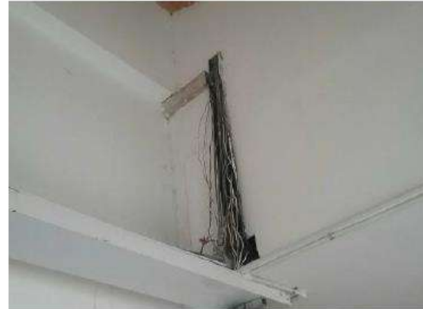
Ilustración 25 Instalaciones eléctricas biblioteca bloque 16
