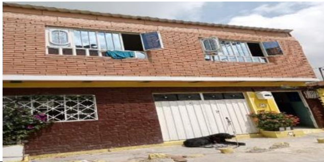
FRENTE SIN ESCOMBROS
