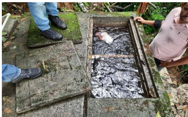
Foto 3. Operatividad interna del sistema de desarenado.
