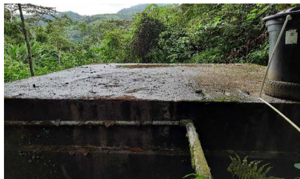
Foto 4. - Tanque de almacenamiento de agua.
