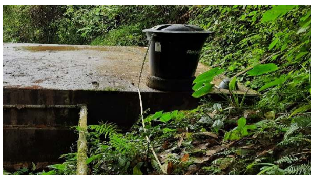
Foto 5. Tanque de cloración para la desinfección del agua de abasto comunitario.
