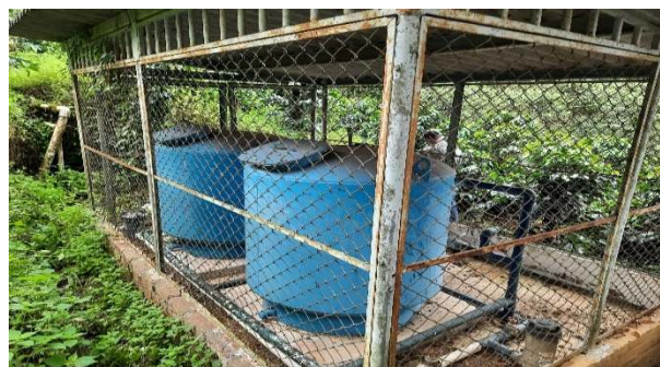
Foto 6. Planta compacta para la potabilización del agua sin funcionamiento.
