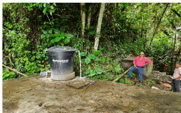
Foto 2. Configuración desarenador - tanque de almacenamiento de agua.
