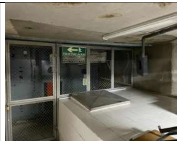
Fotografía 8. Humedad presente en la losa ubicada en el sótano sobre la planta eléctrica
