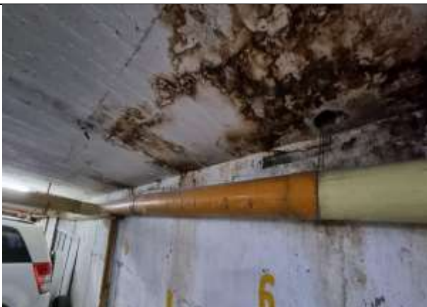
Fotografía 13. Evidencia de humedades en la superficie del sótano del edificio.
