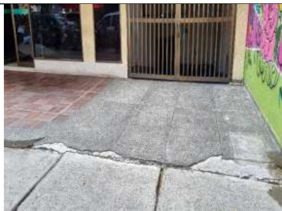
Fotografía 10. Entrada al parqueadero del sótano por donde potencialmente se produzcan las filtraciones que causan la humedad en el sótano.
