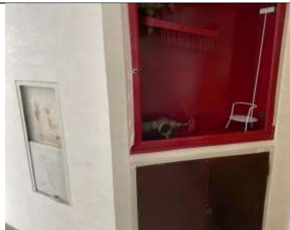
Fotografía 33. Evidencia de elementos faltantes en zonas comunes del edificio.
