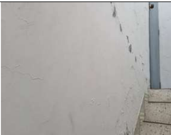
Fotografía 5. Muros de la fachada interna con internos pendientes de mantenimiento.
