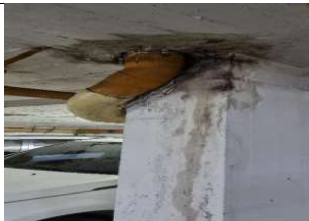
Fotografía 14. Evidencia de humedades en las bajantes del sótano del edificio.
