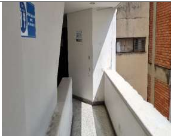
Fotografía 6. Muros y divisiones en pasillo humedades y la pintura desprendida.
