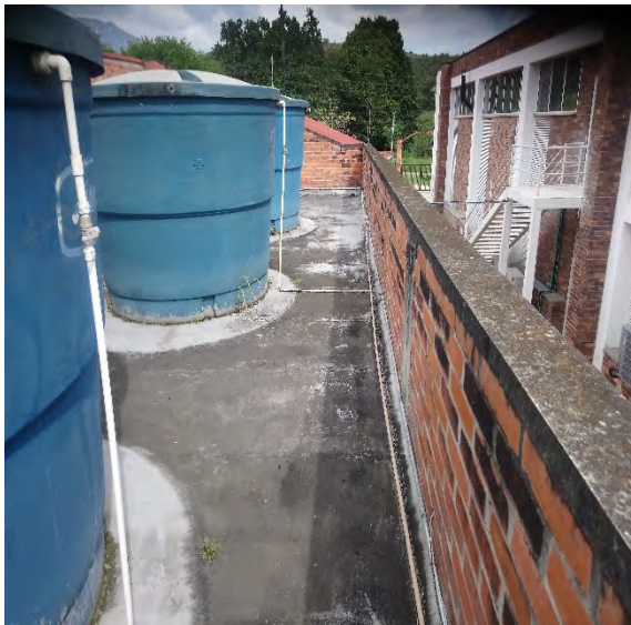
Impermeabilización sin pendientes.
