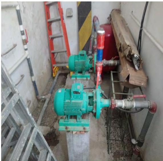
Sistema de bombeo.
