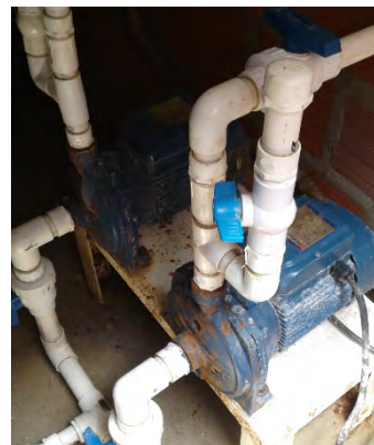
Fotografía 28. Mantenimiento Equipos de presión Los Patios
