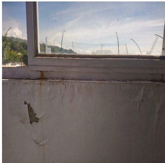
Filtraciones en ventanas.
