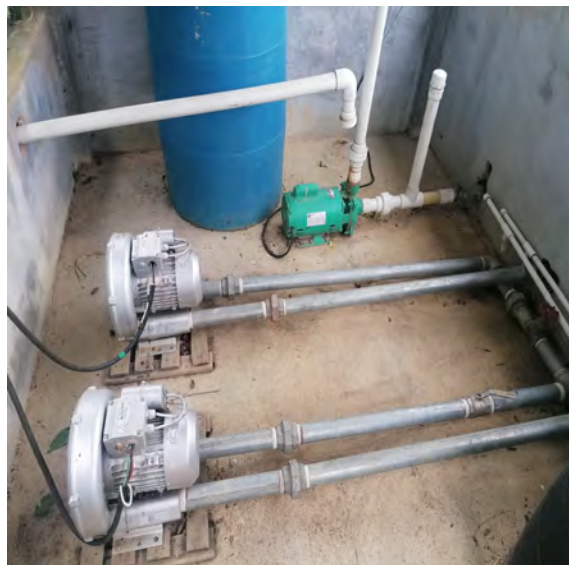
Sistema de bombeo.
