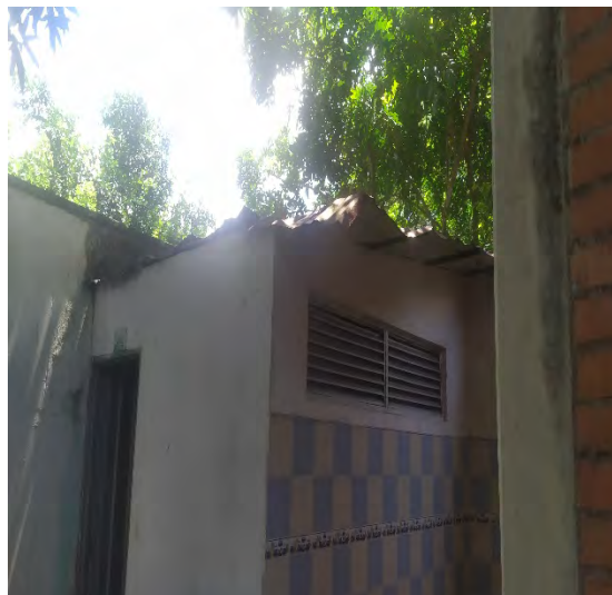
Fotografía 9. Baños tejas en mal estado con goteras
