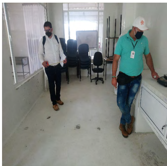
Muros y pisos afectados por el normal Uso, recubrimiento en pintura epóxica.
