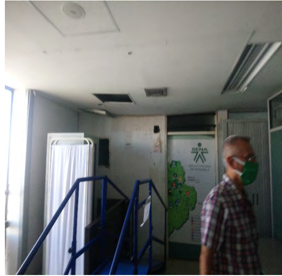
Cielos rasos descolgados en enfermería.
