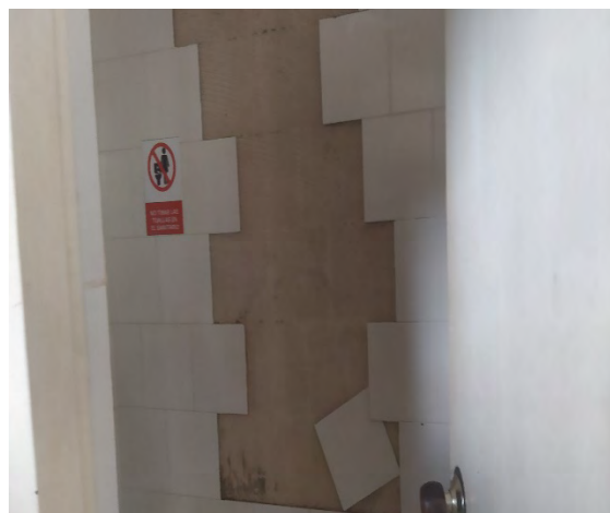
Fotografía 19. Baños, Enchape de pared caído.
