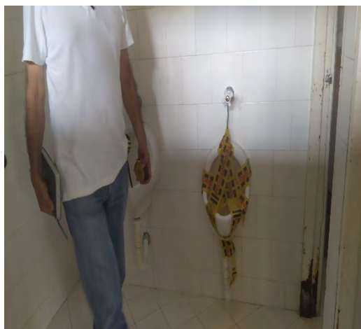
Fotografía 18. Baños fuera de servicios por daños en grifería y tubería sanitaria
