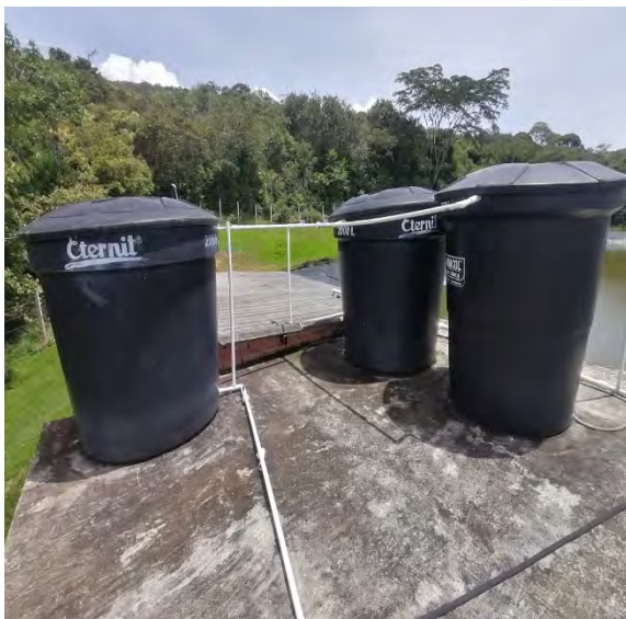
Zona de tanques de almacenamiento para impermeabilización.
