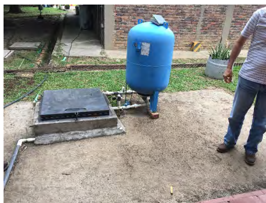
Fotografía 12. Tanque y sistema de bombeo
