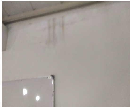
Fotografía 6 humedad por falta de limpieza en viga canales.
