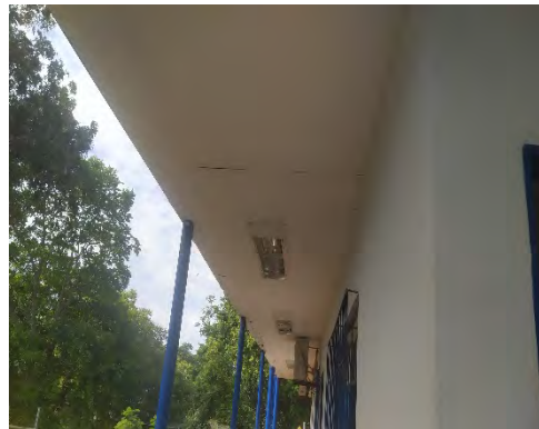
Fotografía 10 Cielorraso con humedad por falta de limpieza de viga canal.
