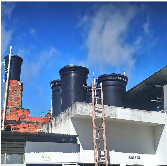
Zona de tanques aéreos.
