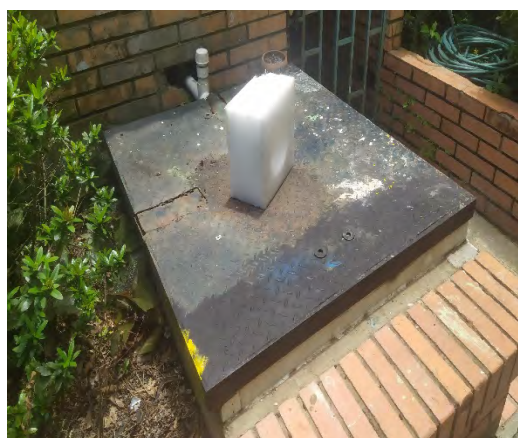
Fotografía 2. Verificación de tanques
