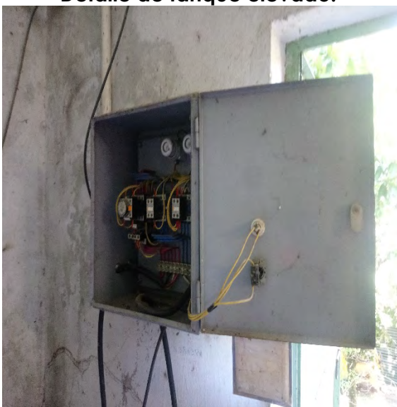
Caja de control de bombeo.
