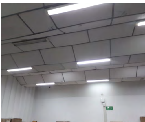
Fotografía 5. Cielo Rasos En Mal Estado
