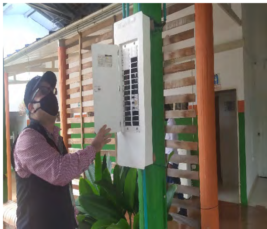
Fotografía 5 caja eléctricas provisionales sin seguridad.
