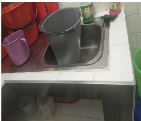
Fotografía 8 Lavaplatos cafetería dañado fuera de funcionamiento
