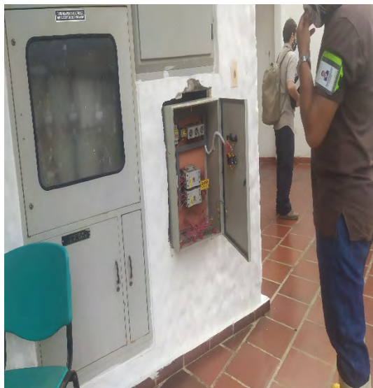
Fotografía 5 caja eléctricas sin Conectar.
