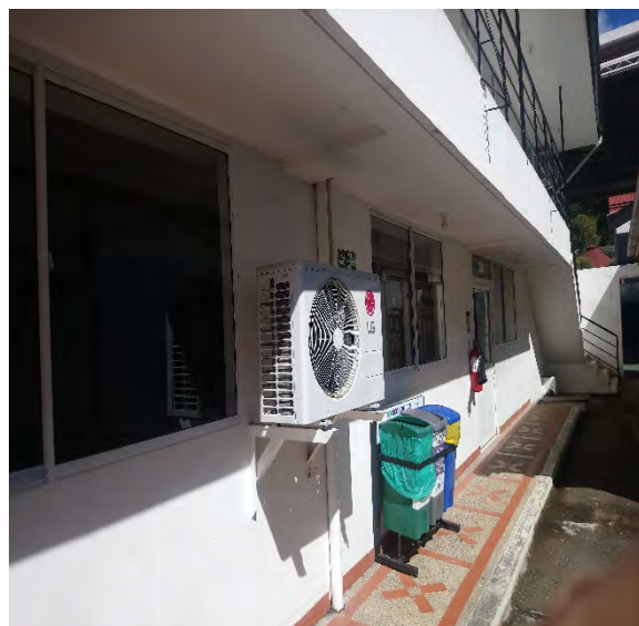
Sistema para aire acondicionado.
