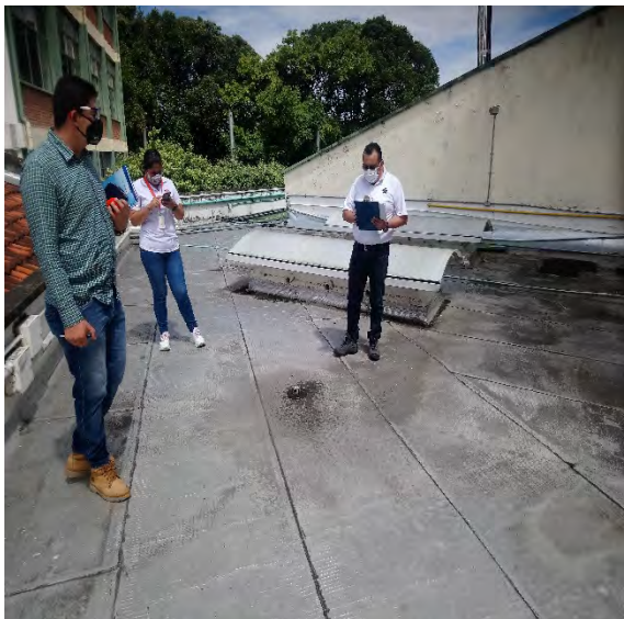
Cielorasto sin pendiente hacia bajantes.
