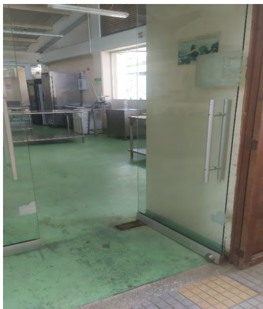
Fotografía 10. Puertas que no cierran y caídas de uno de sus lados que impiden cerrarlas
