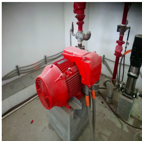
Bomba del sistema contra incendios.
