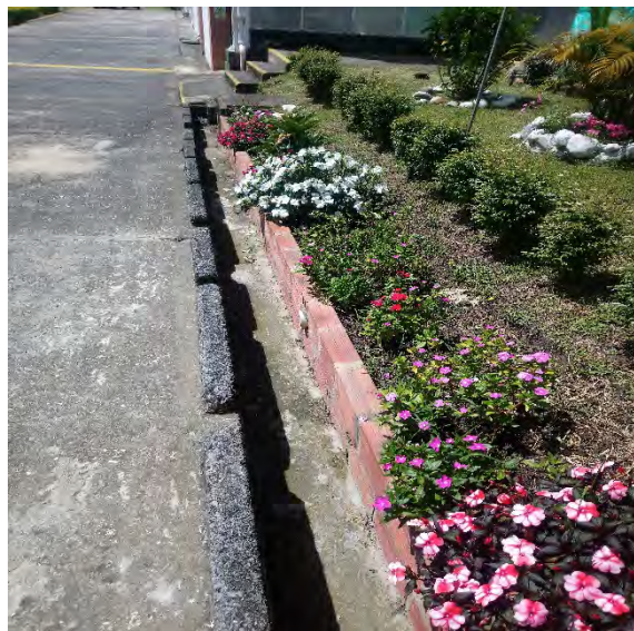
Sumideros para aguas lluvias.
