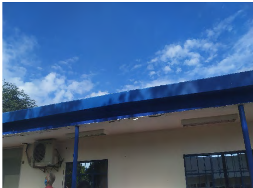
Fotografía 9 Humedad bajo la viga canal
