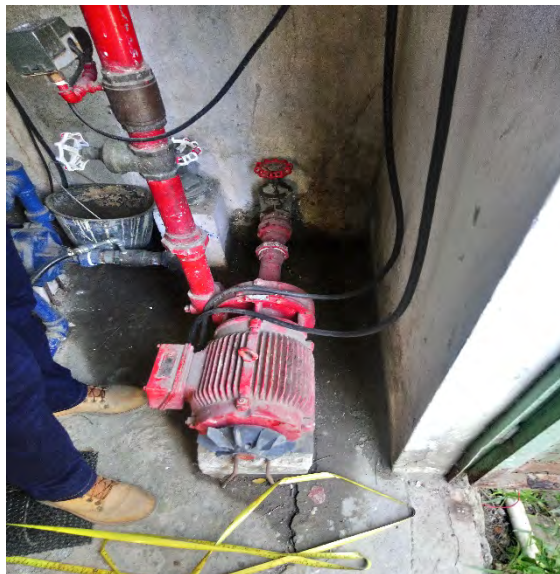
Sistema de bombeo del tanque.
