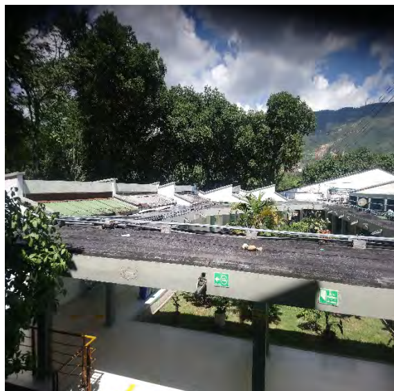
Zona de cubierta – manto desgastado.
