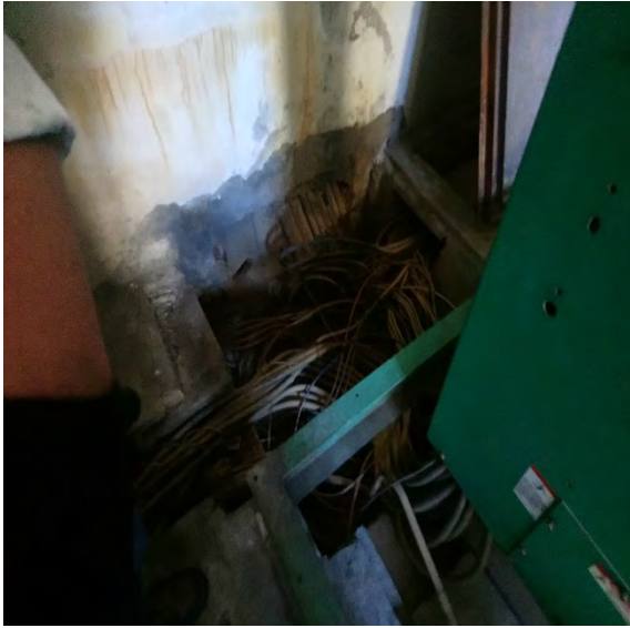
Cableado en área - Planta eléctrica.
