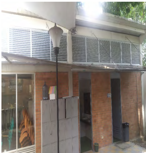
Fotografía 8. Mal estado de templetes del techo
