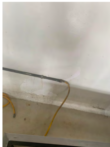
Fotografía 6. Pintura epóxica en mal estado.
