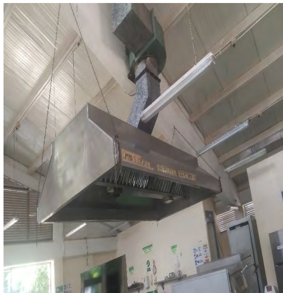
Fotografía 5. Extractor en cocina
