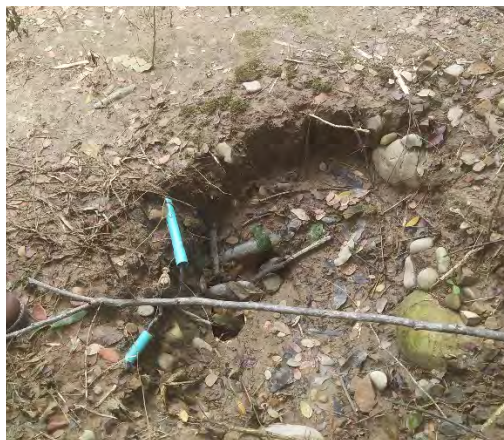
Fotografía 7. Tubería sanitaria y caja de inspección
