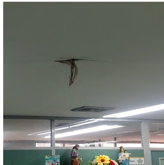
Instalaciones eléctricas deficientes.
