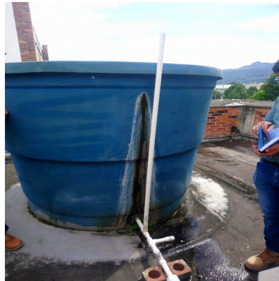
Tanques con problemas de flotadores.
