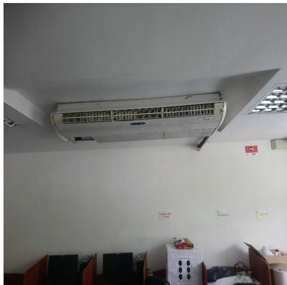
Aires acondicionados existentes.
