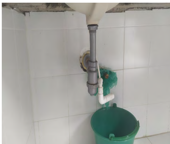
Fotografía 21. Tubería y grifería de lavamanos
