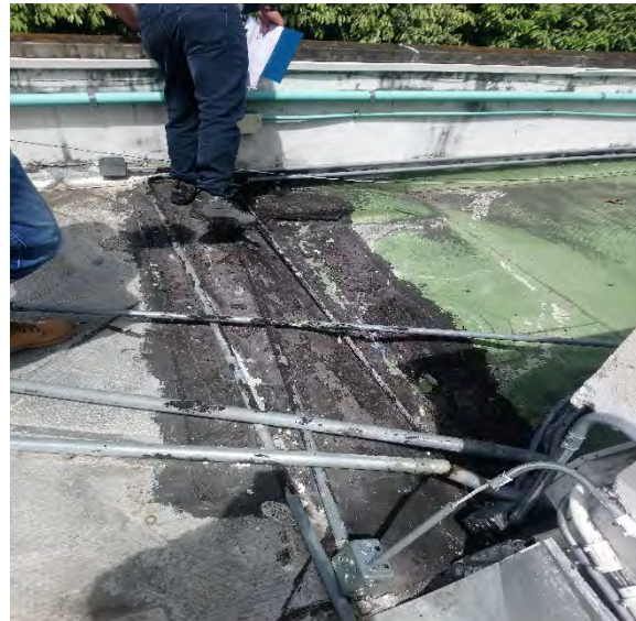
Dilatación mal que ocasiona filtraciones.
