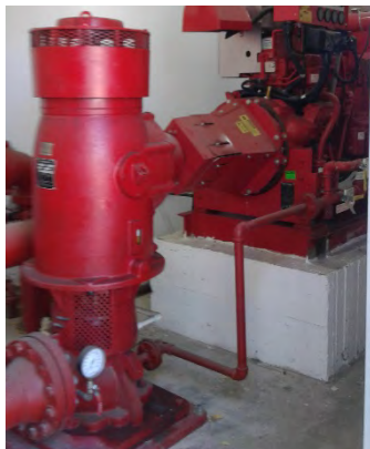
Fotografía 17. Bomba red contra incendio
