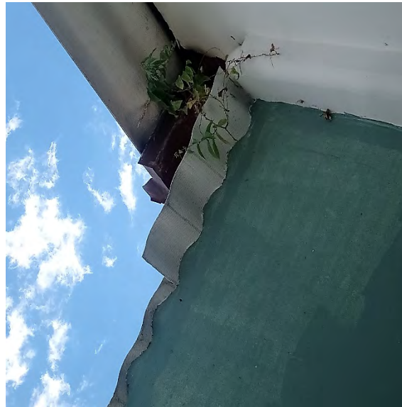
Material vegetal obstruyendo canales.
