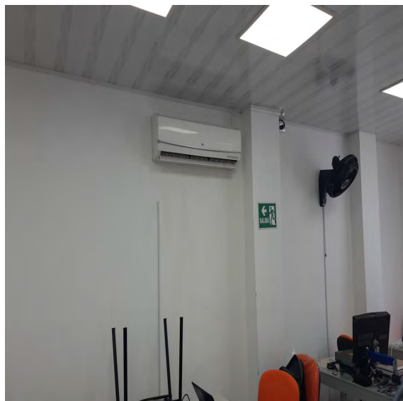
Aire acondicionado minisplit.
