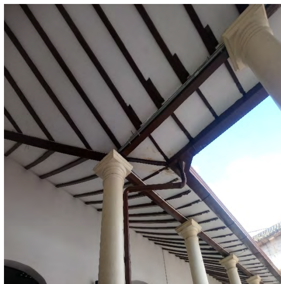
Filtraciones en cubierta y bajantes.
