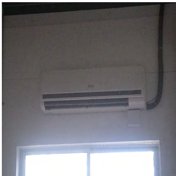
Equipo condensador minisplit.
