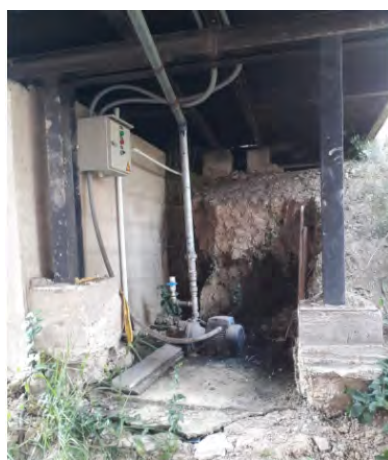
Fotografía 15 equipos de bombeo
