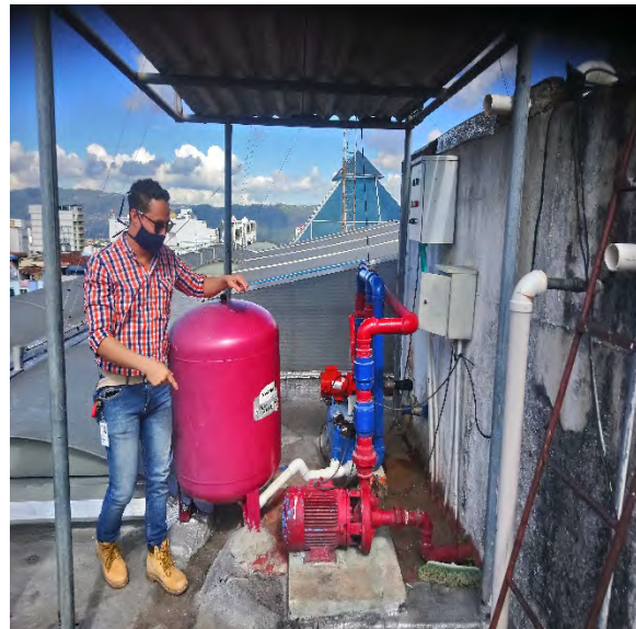
Sistema de bombeo en buen estado.
