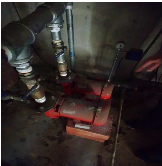
Sistema de Bombeo de agua potable.
