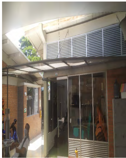
Fotografía 11. Puertas que no cierran y caídas de uno de sus lados que impiden cerrarlas
