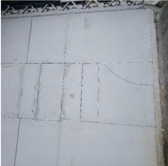
Fachada con problemas de fisuras.
