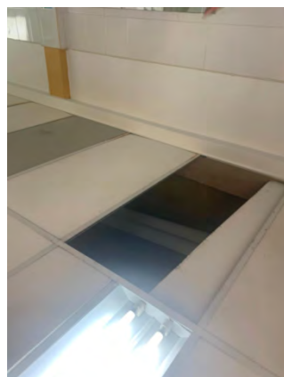
Fotografía 12. Cielo raso en mal estado
