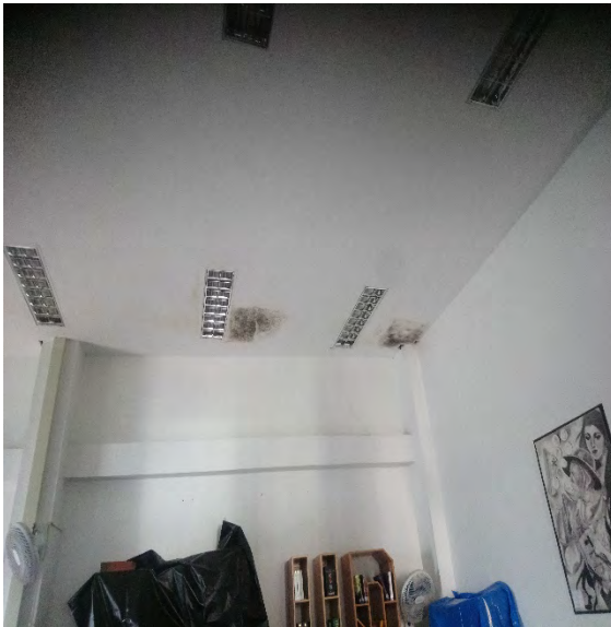
Filtraciones en cielorasos.
