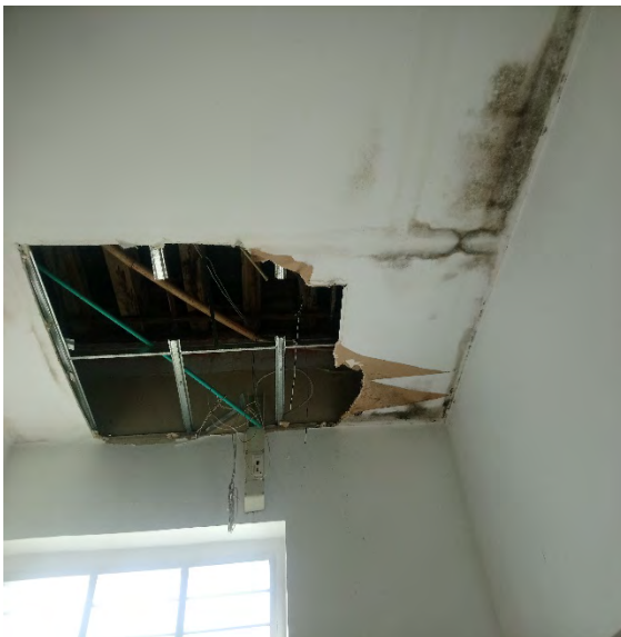
Cielorasos en mal estado.
