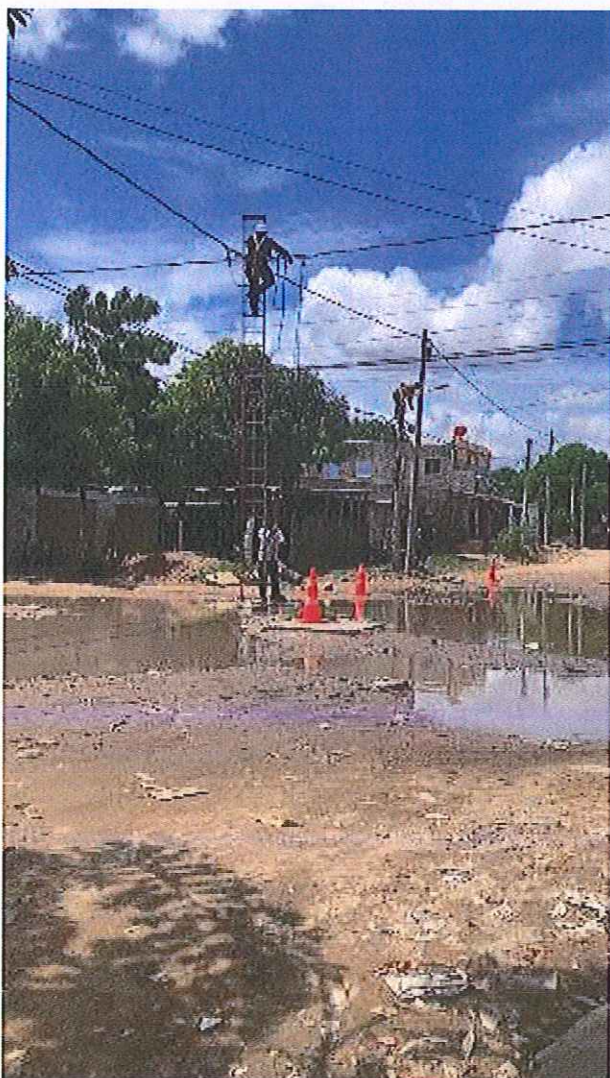
Foto 3. Cruce aéreo trenzado barrio nuevo horizonte
