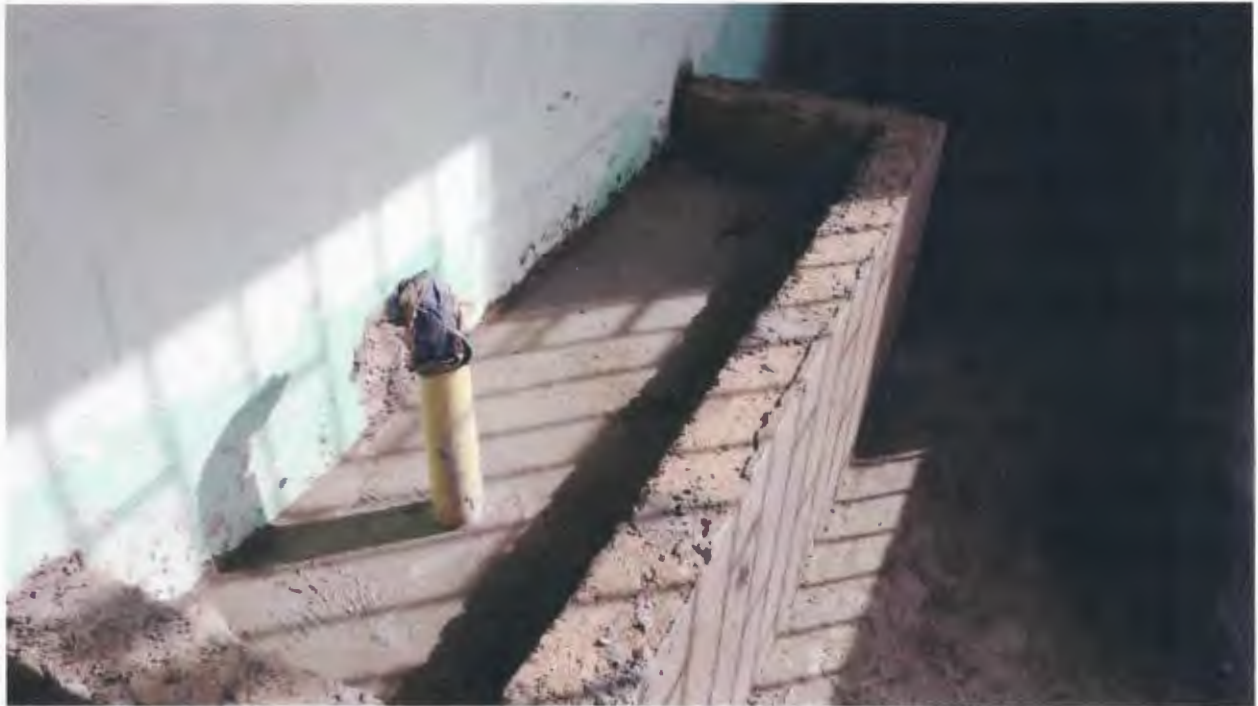
Imagen 11. Lavamanos múltiple, instalación sanitaria
