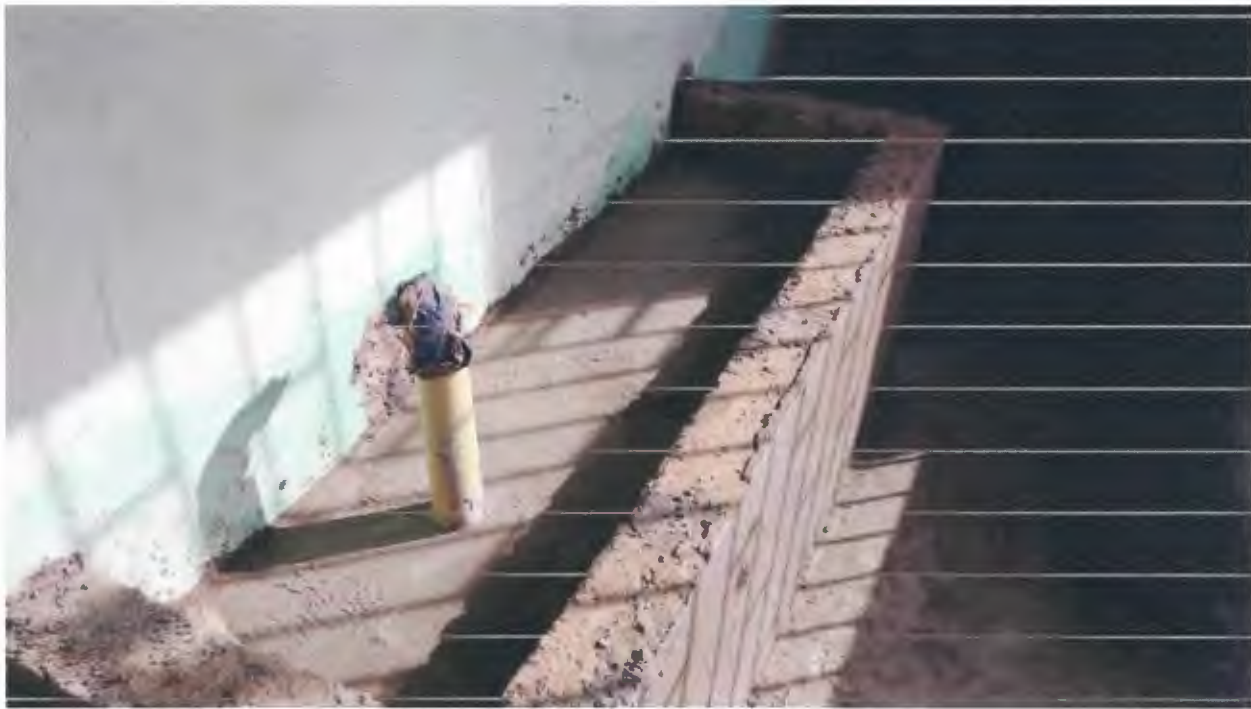
Imagen 11. Lavamanos múltiple, instalación sanitaria
