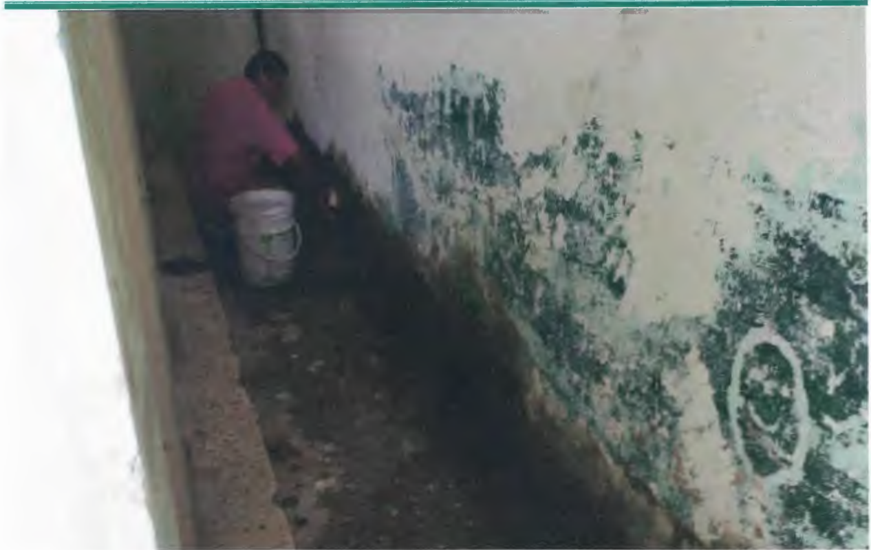
Imagen 7. Pañete en muro pasillo de baños
