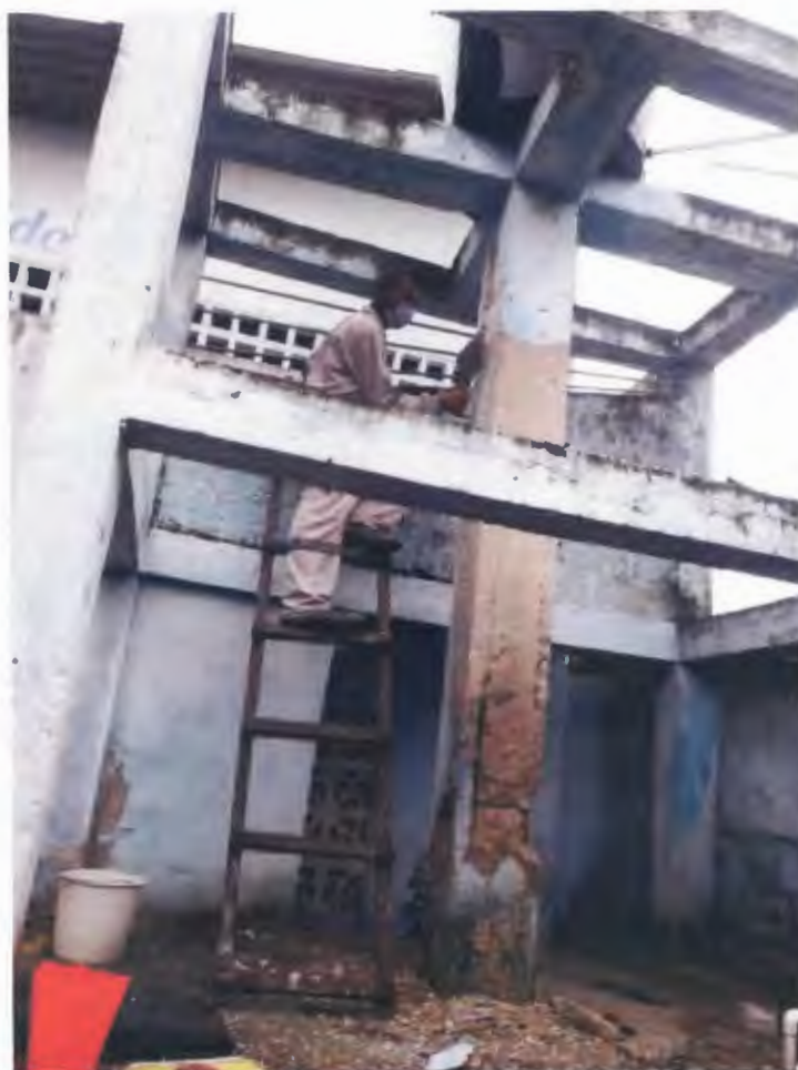
Imagen 29. Columnas de soportes en mal estado
