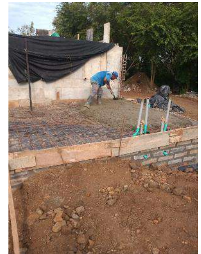
CUARTO DE BOMBAS
