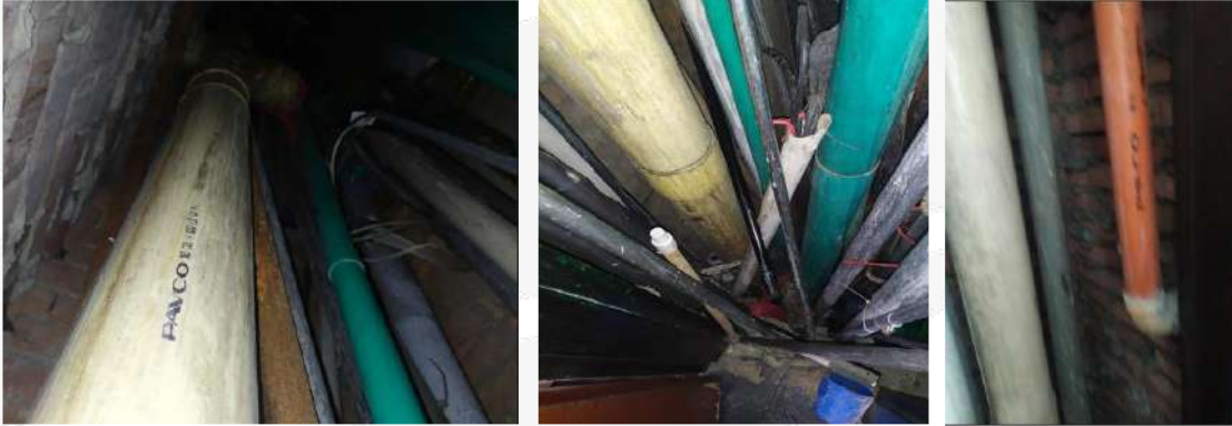
bajantes de aguas residuales y tub de re ventilación en color naranja
