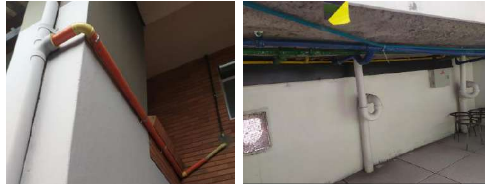
Redes sanitarias y desagües de la zona de laboratorios,
