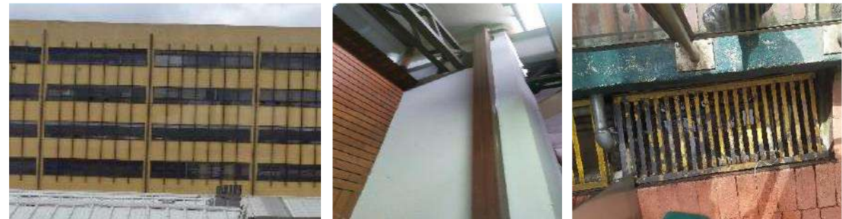
Bajantes descendentes de cubiertas y cárcamos de drenaje
