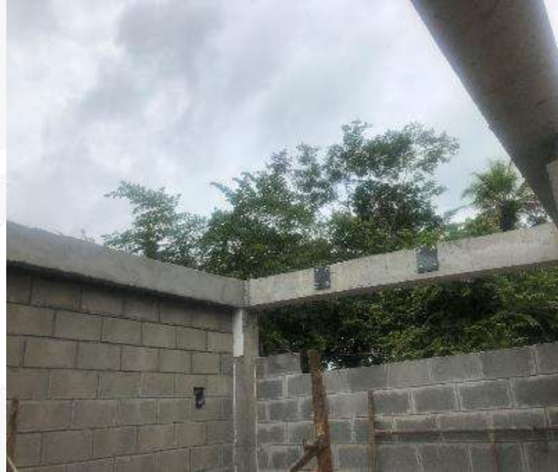
platinas cuarto de bombas
