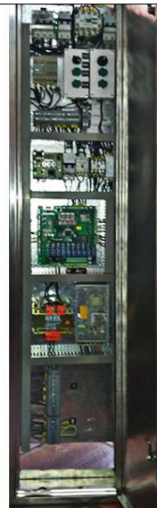
Maniobra electrónica (última tecnología sin cuarto de máquinas)
