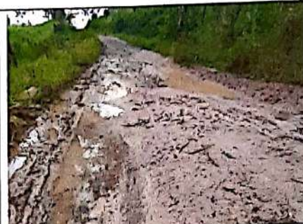
Imagen 8. Vereda Laurel Alto, vía afectada por hundimiento del suelo y aguas lluvia.
