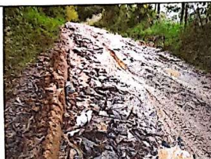
Imagen 9. Vía que conduce de la vereda Laurel Bajo a Laurel Alto, afectada por hundimiento del suelo.
