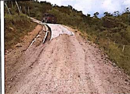
Imagen 10. Vereda Laurel Bajo, sector escuela Laurel. Vía afecta por hundimiento (posible fenómeno de reptación)
