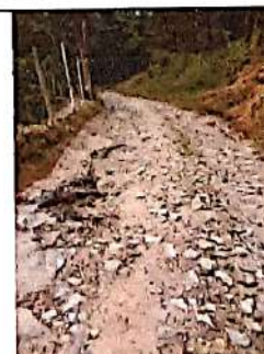
Imagen 14. Vereda el Carmen sector escuela, vía afectada por hundimiento (posible fenómeno de reptación)
