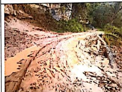
Imagen 13. Vereda El Carmen Sector Pollo, vía afectada por hundimiento.
