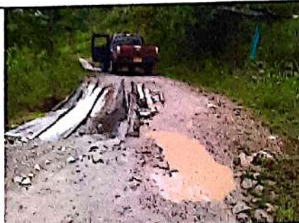
Imagen 7. Vereda Laurel Bajo, vía afectada por hundimiento del suelo.
