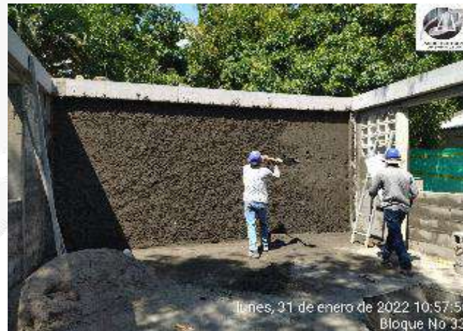
PAÑETE MAMPOSTERIA Y ESTRUCTURA INTERNA
