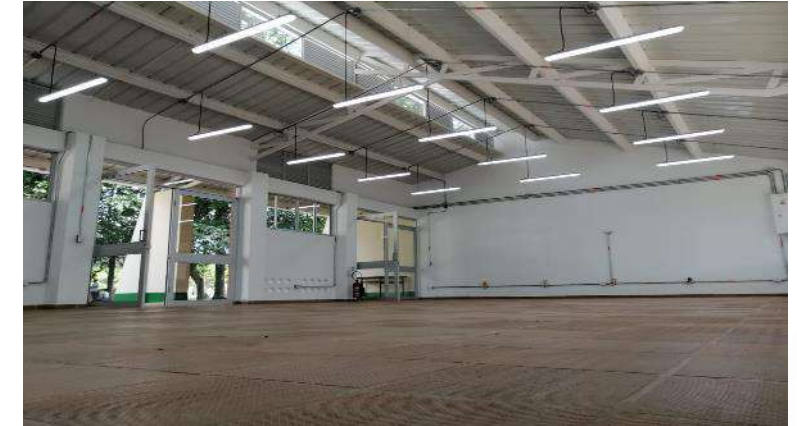
REVISIÓN DE FUNCIONAMIENTO COMPONENTE ELÉCTRICO
