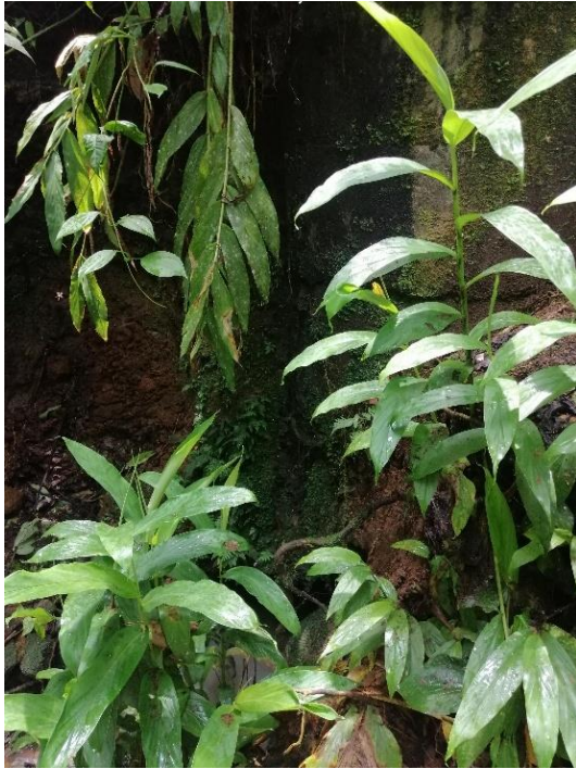
4. COLECTOR EN MAL ESTADO
