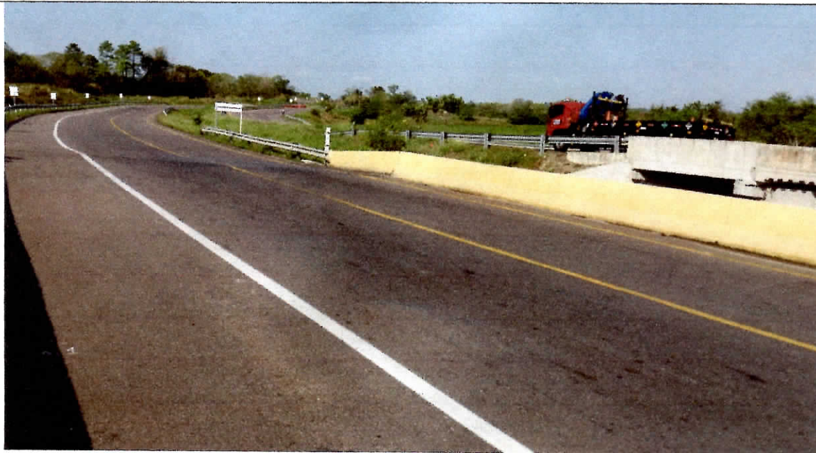
ESTADO DE LA CARPETA Y DIFERENCIA DE NIVEL CON LA VIA CALZADA SUR
