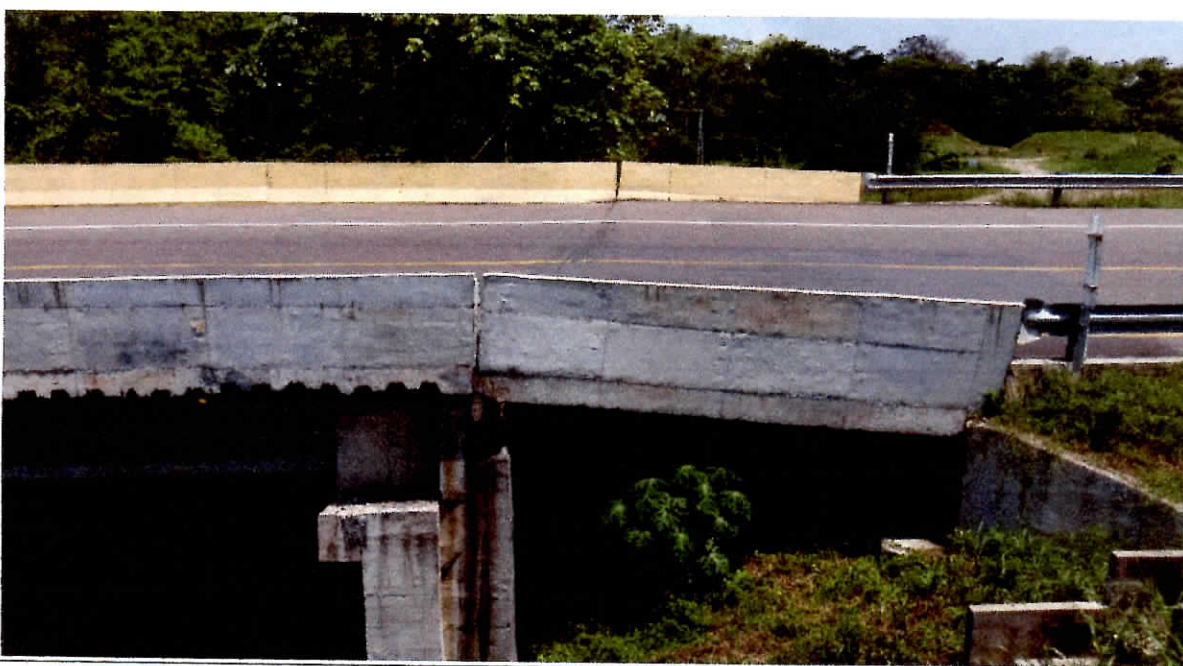
ESTADO DE LA CARPETA Y DIFERENCIA DE NIVEL CON LA VIA CALZADA NORTE
