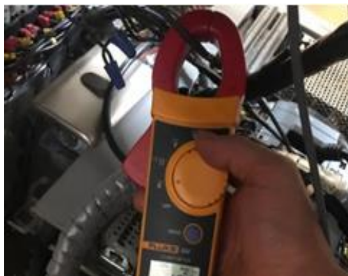
Se monitorean corrientes ventiladores.
