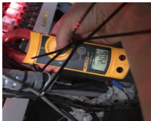
Se monitorean corrientes eléctricas.
