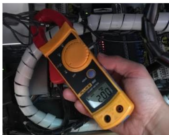
Se monitorean corrientes eléctricas.
