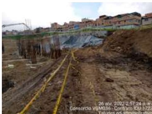
Fotografía 4. Afectaciones de la obra luego de las fuertes lluvias presentadas en los últimos días.
