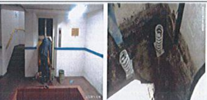
FOTOGRAFÍA No. 29: PARQ. No 8 COUNTRY 85 - Arreglo Filtracion en foso de ascensor
