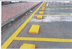
FOTOGRAFÍA No. 44: PARQ. No 1: CALLE 125 - Pintura tráfico amarilla Topellantas
