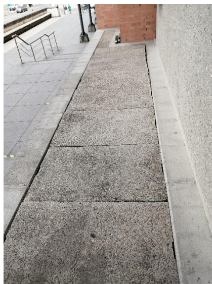
Fotografía N° 9: Losas en concreto dilatadas
