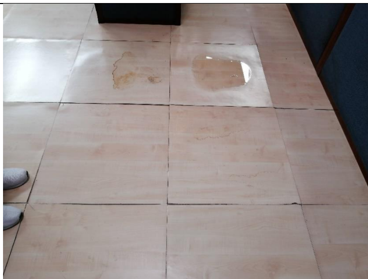
Fotografía N° 8 Desprendimiento de revestimientos en piso
