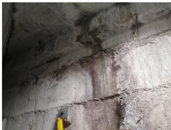
Fotografía N° 12 Filtración de agua en placa de sótano
