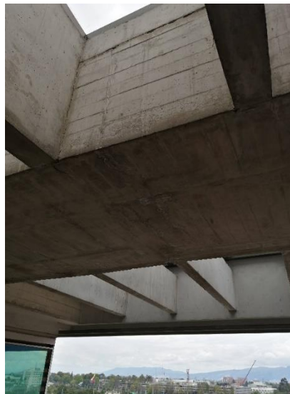
Fotografía N° 7 Fisuras en elementos estructurales
