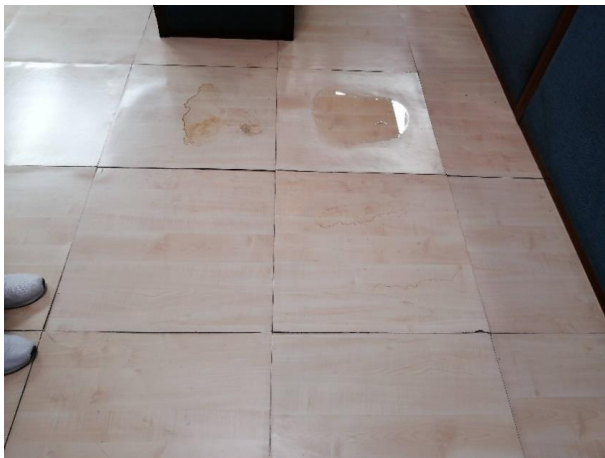
Fotografía N° 8 Desprendimiento de revestimientos en piso
