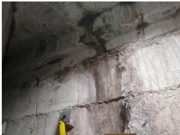
Fotografía N° 12 Filtración de agua en placa de sótano
