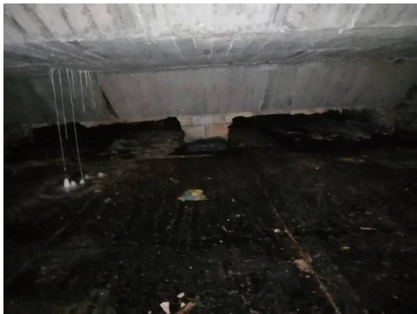
Fotografía N° 11 Formación de estalactitas por filtración de agua bajo rampa vehicular
