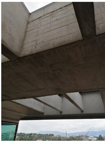
Fotografía N° 7 Fisuras en elementos estructurales
