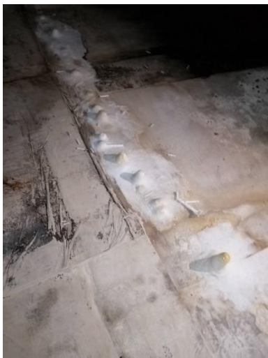
Fotografía N° 10 Formación de estalactitas por filtración de agua bajo rampa vehicular
