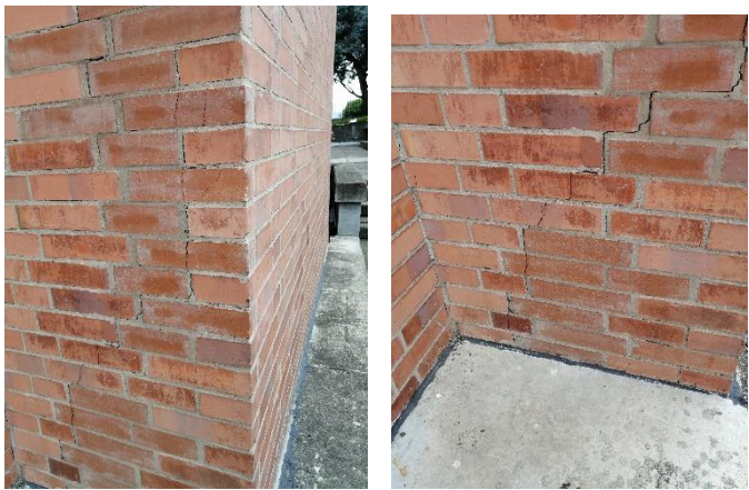
Fotografías N° 5 y 6 Fisuras en muros de fachada
