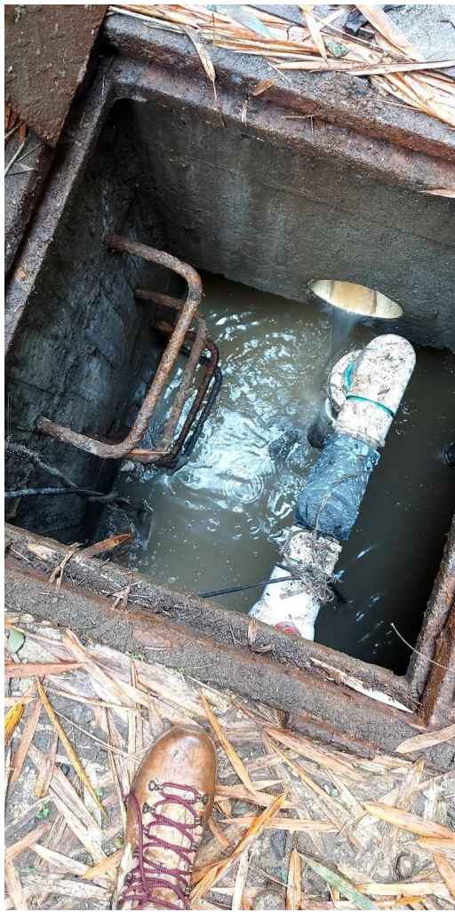
Fotografía 7. EBAR 2 - Aguas residuales provenientes las casas de conjunto residencial con vertimiento al cuerpo hídrico Q. La Orlanda.
