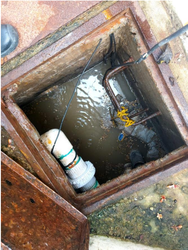
Fotografía 3. EBAR 1 - Aguas residuales provenientes de los apartamentos y las casas de conjunto residencial con vertimiento al cuerpo hídrico Q. La Orlanda.
