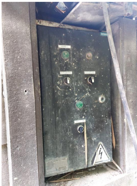
Fotografía 68. Tablero de control de EBAR 2.
