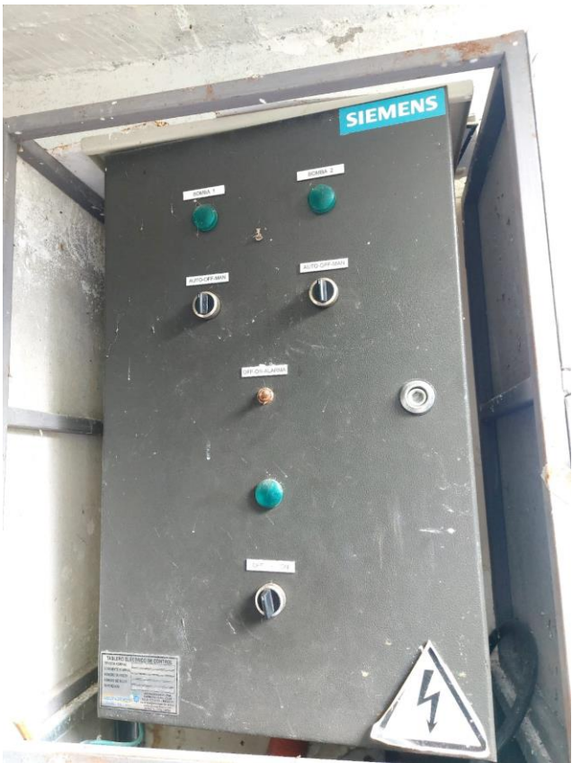
Fotografía 4. Tablero de control de EBAR 1.
