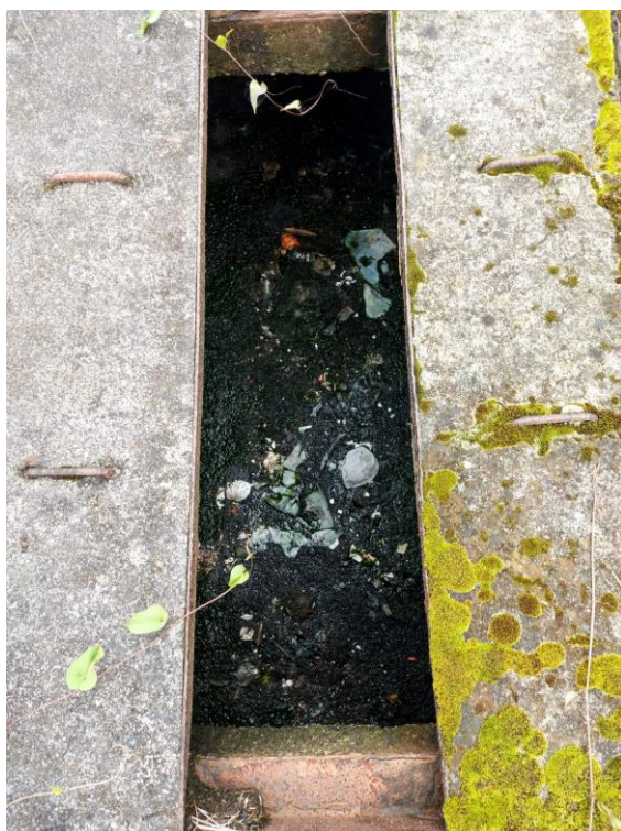
Ilustración 5. Sistema colmatado. No cuenta con todas las tapas, por lo que cuando hay precipitación el nivel de agua aumenta dentro del sistema.
