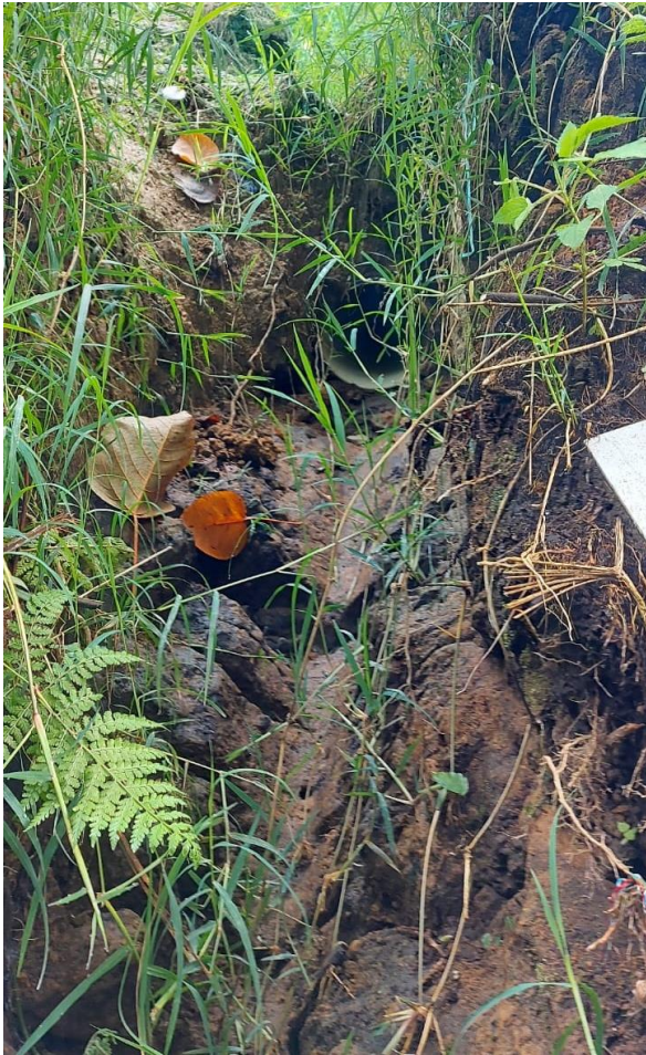
Fotografía 1: Tubería Novafort que dispone sobre predio del denunciante.
