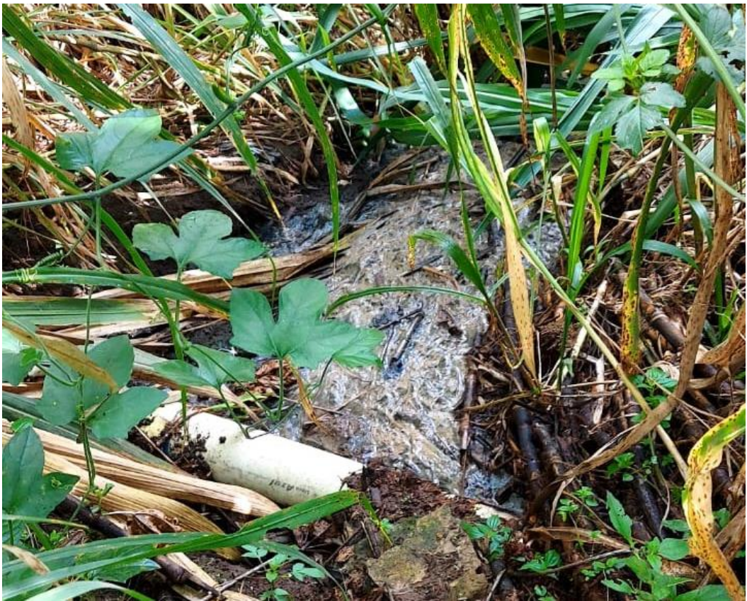
Fotografía 2. Tubería en mal estado que genera vertimiento a escasos metros de llegar tubería de descargue.
