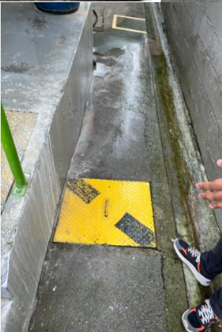
Cámara interna de salida de aguas residuales tratadas.
