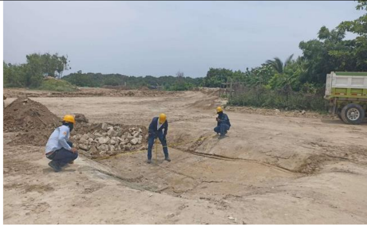
Extracción de fallos de la subrasante parqueadero Estación Las Flores
