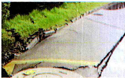
Foto 5. Agrietamiento de tendencia longitudinal a la vía, por donde continua el ingreso de aguas lluvias,
