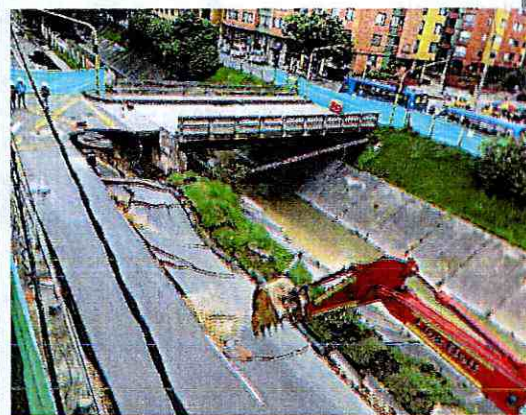
Foto 16. Vista general vía afectada, canal comuneros y puente Carrera 60. Seguimiento del 08/06/2022
