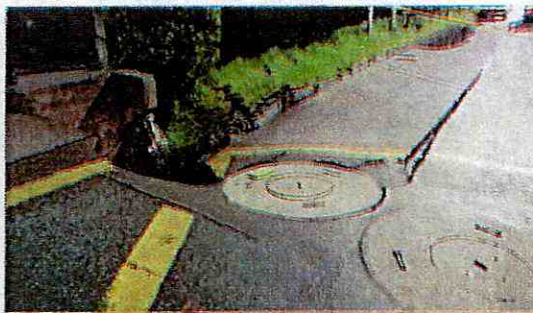
Foto 2. Vista general del hundimiento el carril izquierdo aferente al extremo sur del puente vehicular
