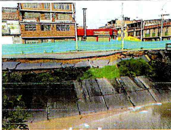
Foto 15. Vista General Vía Colapsada Seguimiento del 08/06/2022
