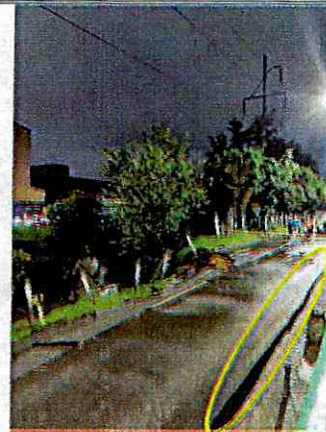
Foto 10. Vista general separación estructura de pavimento del andén costado sur (Seguimiento 0706/2022 21:00hrs)
