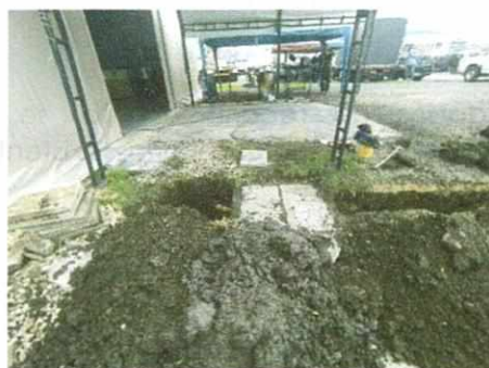
Caja salida baños
