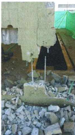
Refuerzo sin traslapo efectivo
