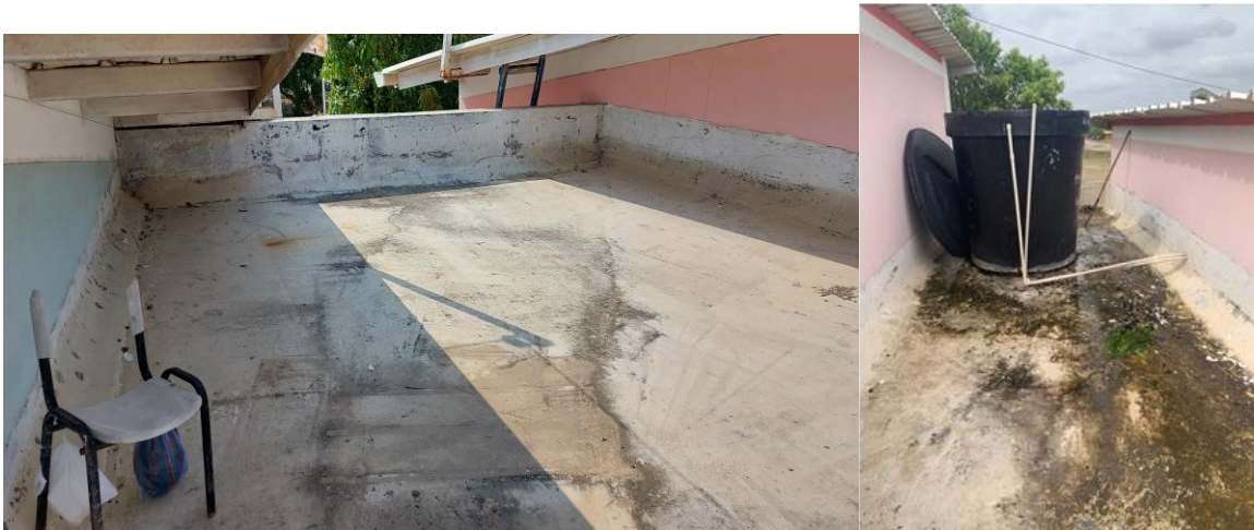
Foto 8. Filtraciones de aguas por cubierta en concreto por agrietamientos, pendientes mínimos para desagües y falta de impermeabilización adecuado.
