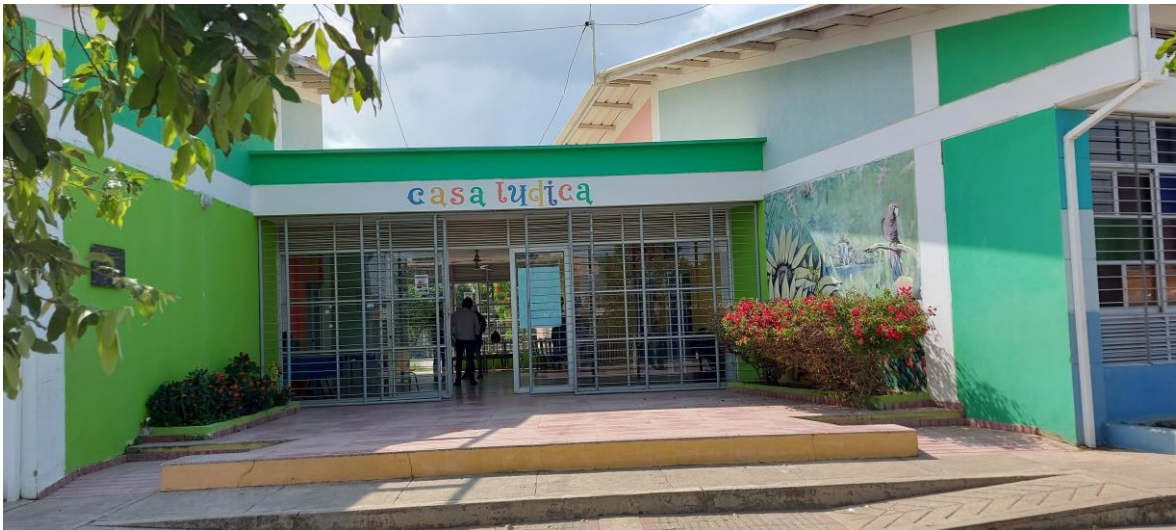
Foto 1. Infraestructura deteriorada (fachadas desgastadas, protectores de ventanas oxidados)
