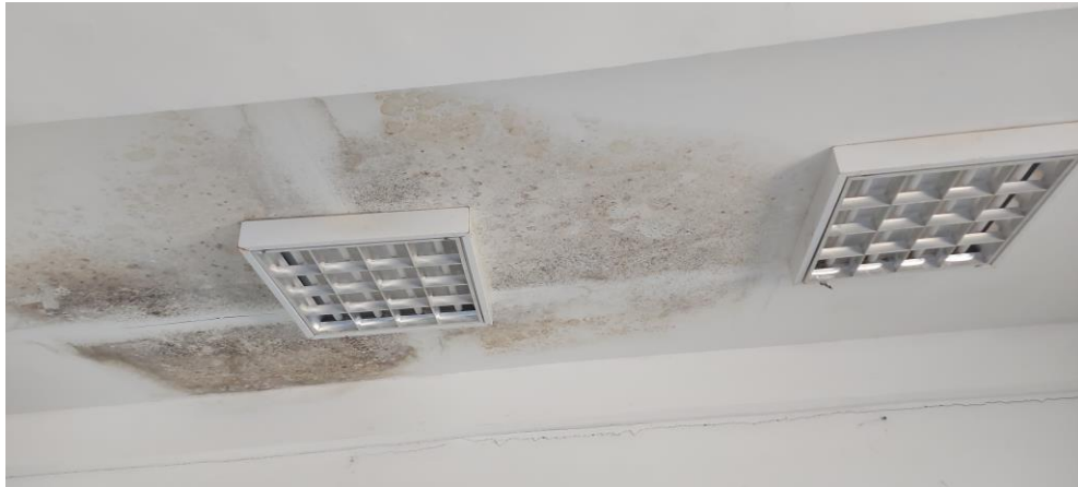
Foto 10. Deterioro de cielo raso por filtraciones de la cubierta en auditorio
