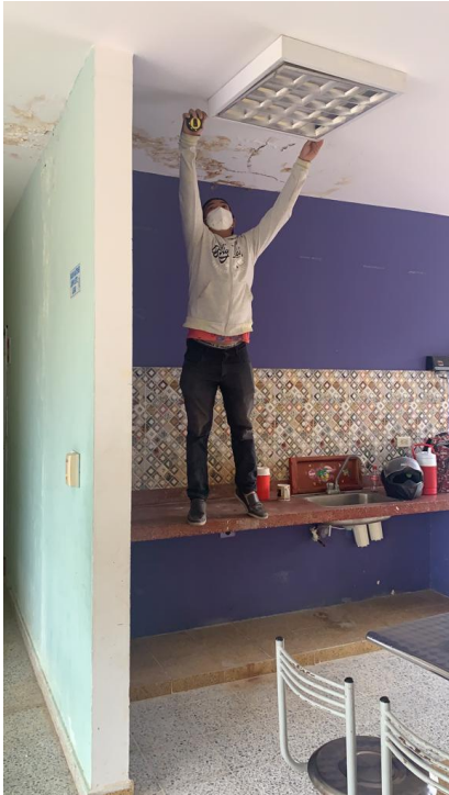
Foto 5. Deterioro luminarias por humedades
