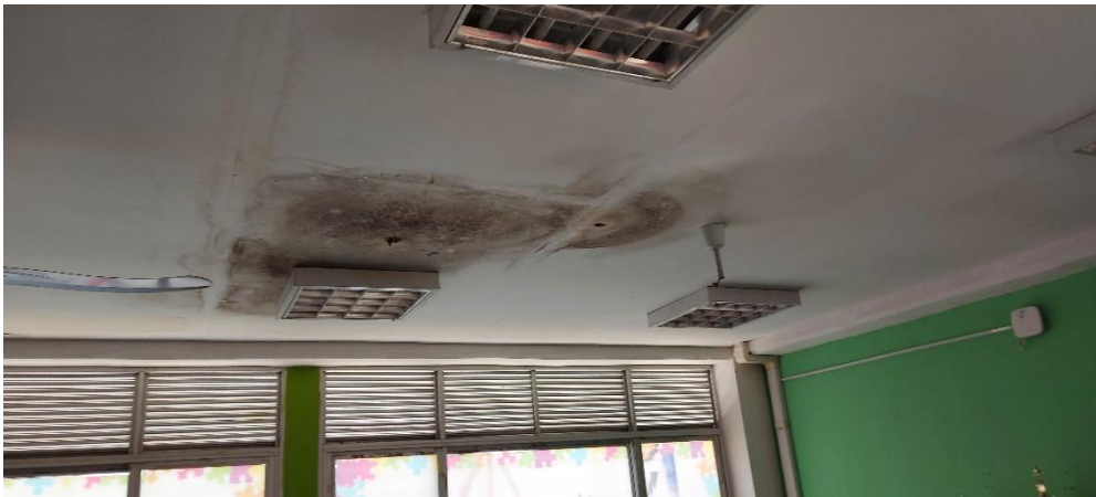
Foto 9. Deterioro de cielo raso por filtraciones de la cubierta en aula múltiple
