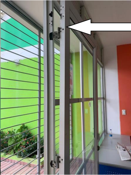
Foto 3. Deterioro puerta de acceso principal
