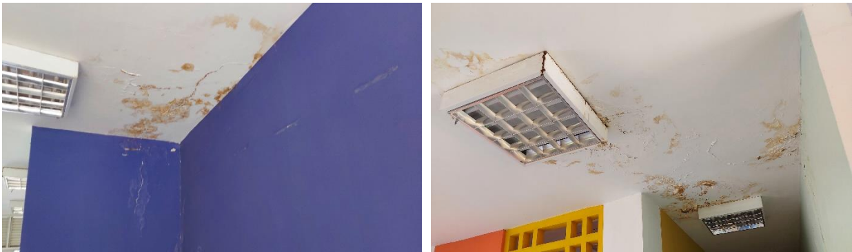
Foto 9. Filtraciones de aguas proveniente de cubierta; deterioro de estuco de cielo raso
