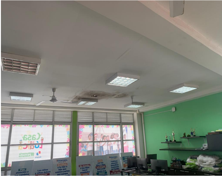
Foto 2. Falta de mantenimiento de luminarias
