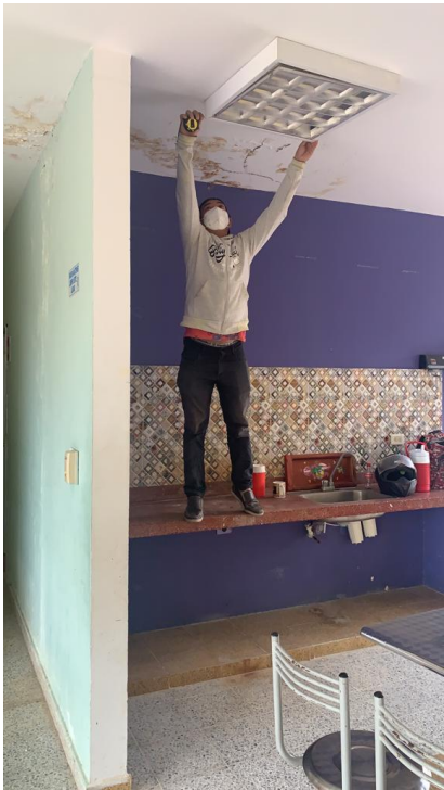
Foto 5. Deterioro luminarias por humedades
