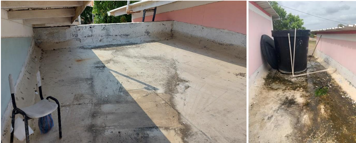
Foto 8. Filtraciones de aguas por cubierta en concreto por agrietamientos, pendientes mínimos para desagües y falta de impermeabilización adecuado.
