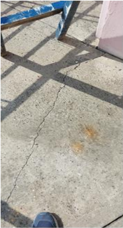
Foto 6. Agrietamiento de piso exterior en concreto
