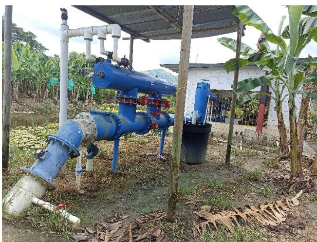
Figura 19. Estación de Bombeo Finca la corona.
