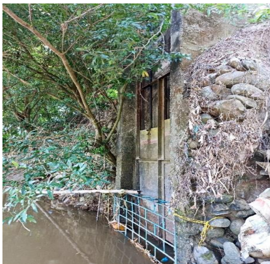
Figura 14.. Captación Finca Don Fuad 1 y 2 10°52'42.6" W 74°11'08.9"
