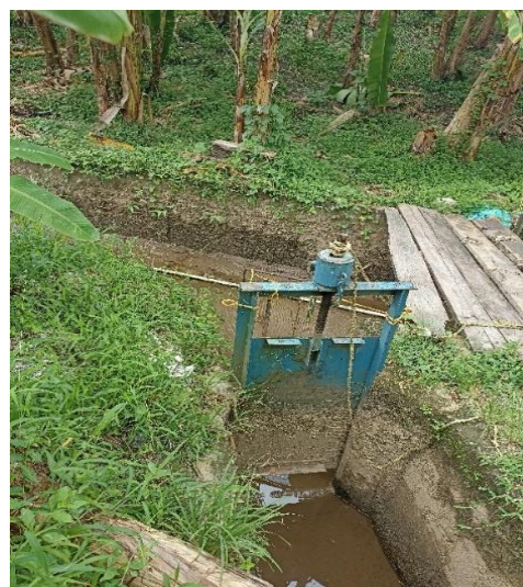
Figura 6. Captación Finca Esperanza Las Mercedes captación coordenadas N 10° 54' 24.4" W 74° 09' 39.6"
