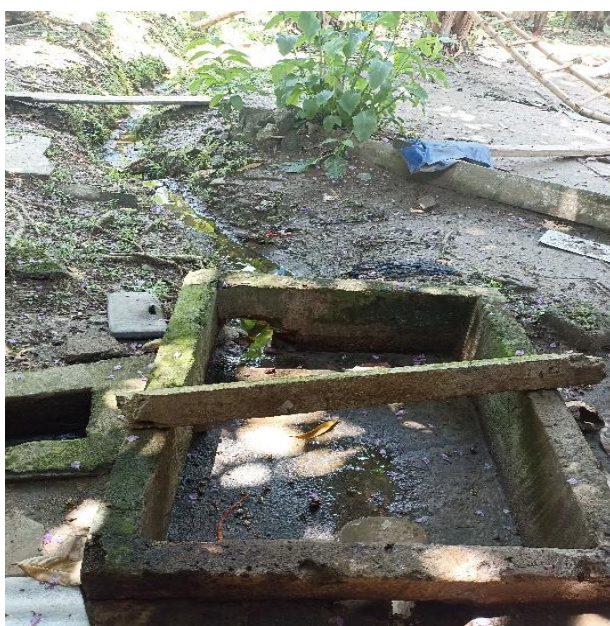
Figura 21. Sistema de Tratamiento finca la isabel
