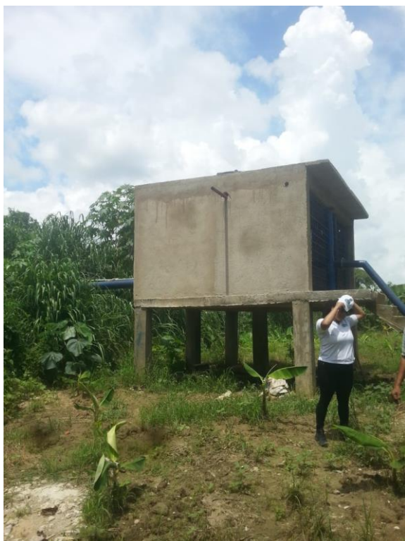
Figura 53. Estación de bombeo.
