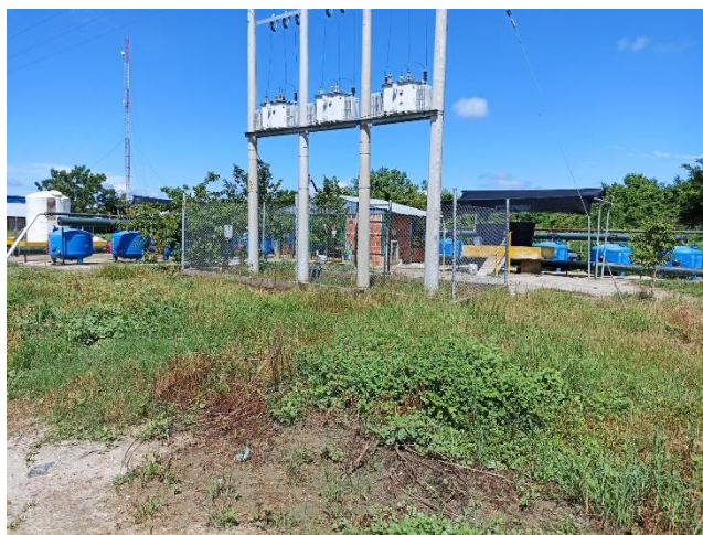
Figura 25. Sistema de Bombeo Finca El Rubí 31 de Mayo de 2022.
