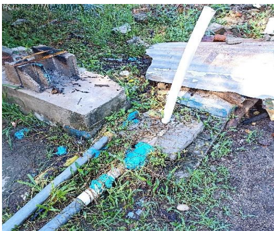
Figura 15. Pozo Finca San Jose.
