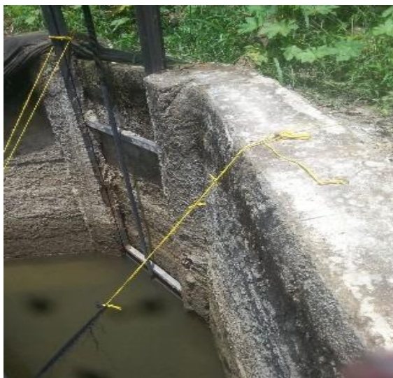
Figura 11. Captación Finca Jose Fina 1 y 2 10°52'42.6" W 74°11'08.9"
