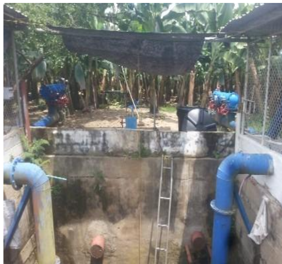
Figura 10. Sistema de Bombeo Finca Don fudad.
