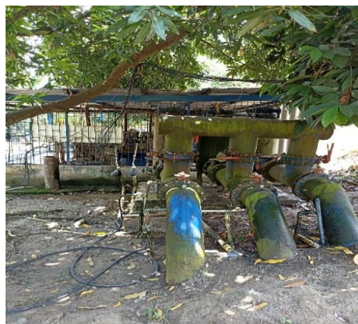
Figura 17. Sistema de Bombeo Finca Don fuad.
