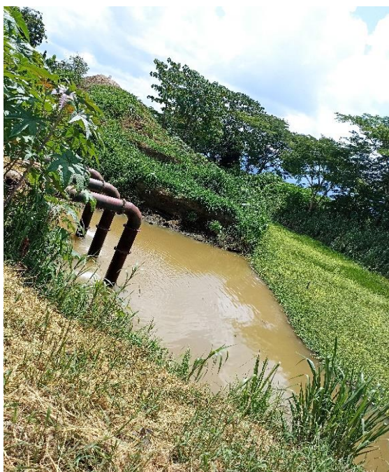
Figura 18. Reservorio Finca Don fuad 1 y 2.
