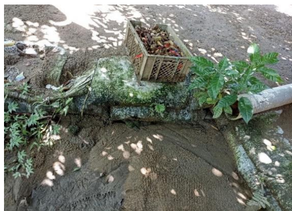
Figura 4. Sistema de Tratamiento y vertimiento.
