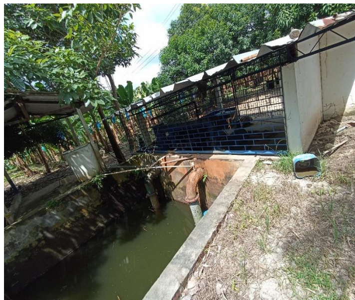
Figura 30. reservorio y sistema de bombeo finca el trebol.
