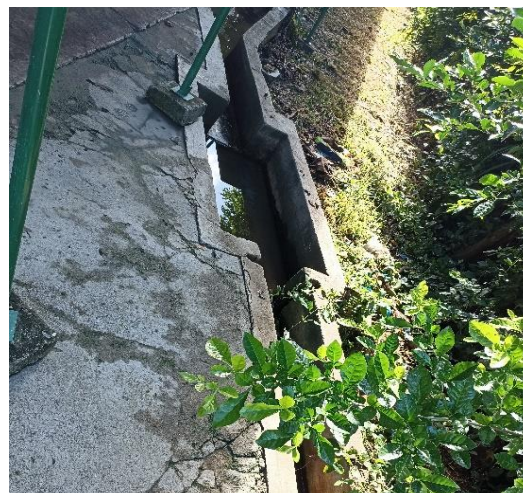
Figura 14. Sistema de Tratamiento Finca San Jose.
