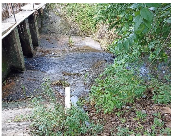
Figura 27. Vertimiento Finca Naranjo.
