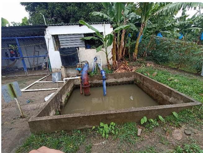
Figura 11. Estación de Bombeo Finca la corona.
