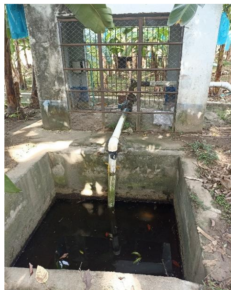
Figura 35. Sistema de bombeo y tanque de almacenamiento.
