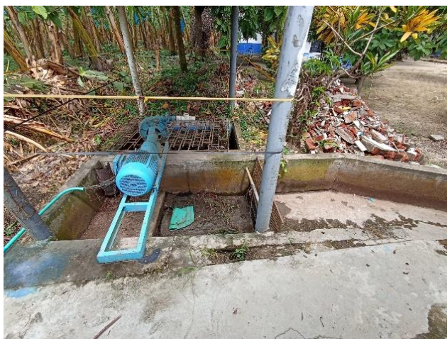
Figura 32. sistema de tratamiento el trébol coordenadas N 10°53'22.4" W 74°12'11.0"
