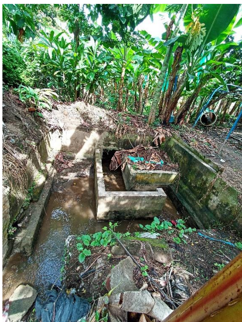
Figura 21. Sistema de tratamiento Finca San Jose 2
