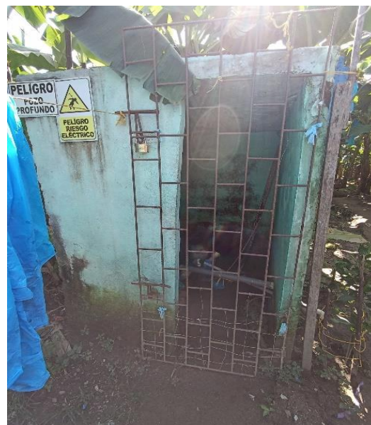
Figura 19. Pozo Finca san juan N 10°53'29.7" w 74°11'34.9"
