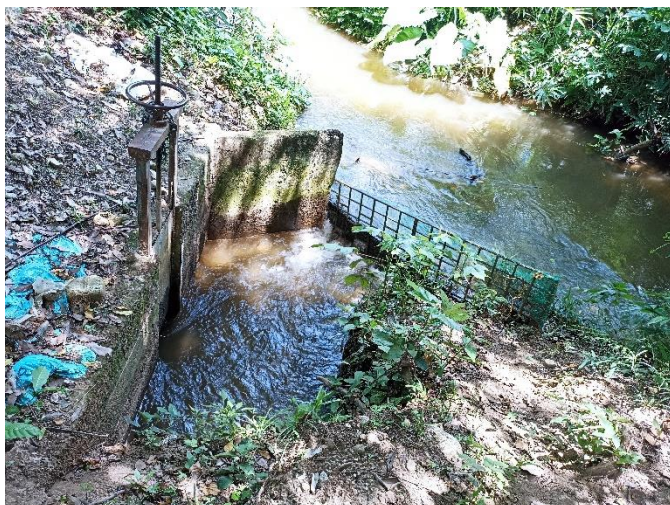
Figure 4 Captación Finca el Aguas claras N 10° 53' 48.8" W 74° 09' 23.6" altitud: 34 msnm
