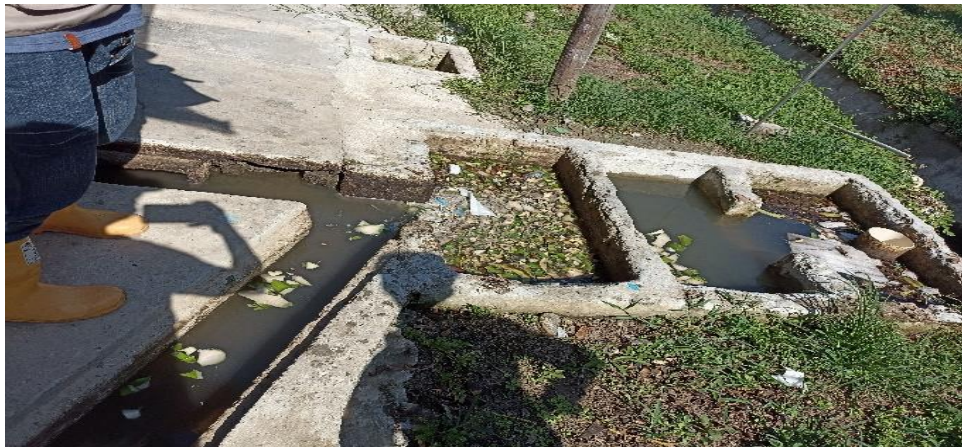
Figura 7. Sistema de Tratamiento Finca Vega Caballero.
