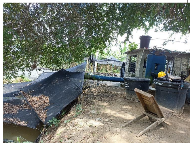
Figure 3 Sistema de Bombeo Finca Aguas claras N 10° 54' 24.3" W 74° 09' 32.7" 31 de Mayo de 2022.
