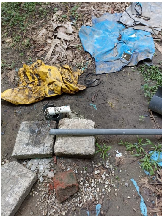
Figura 36. pozo profundo finca san juan 2.
