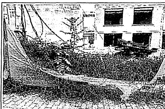
Se observa cerramientos en mal estado y residuos cubiertos por la vegetación en bloque E (Alojamientos).
