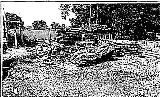
Acopio de materiales deficientes, estos deben estar claramente identificados demarcados, señalizados y en orden. Bloque E (Alojamientos).
