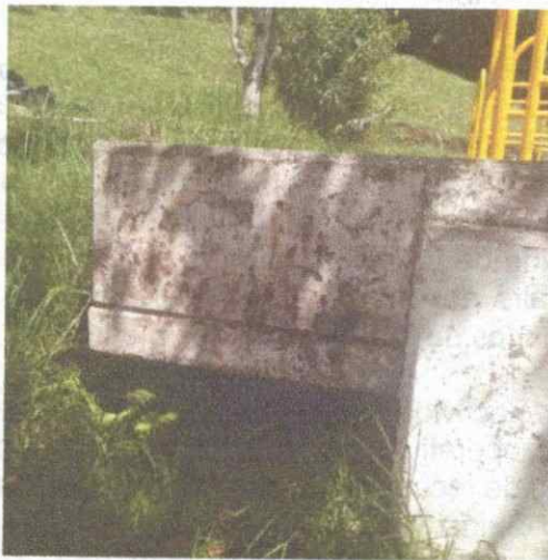
Foto 1. Estado de la canaleta
