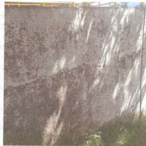
Foto 2. Estado del sedimentador
