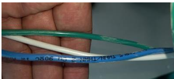
Foto No 3: Conductores No 12 AWG de cableado por canaleta sin especificaciones de bajo contenido de halógenos.
