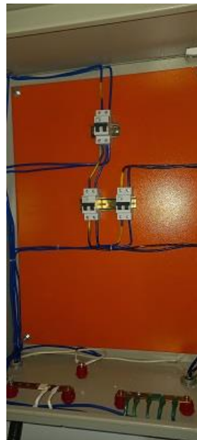
Foto No 6: Tablero eléctrico bifásico regulado instalado con solo 3 Breakers de 50 amperios sin los elementos requeridos en el ítem NP8, ni acometidas de entrada y salida para la UPS
