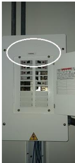
Foto No 10: tableros eléctricos de 18 circuitos instalado sin espacio para totalizador
