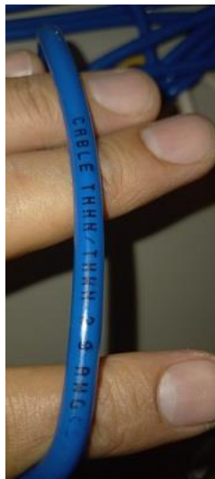
Foto No 2: Conductor No 8 AWG sin especificaciones de bajo contenido de halógenos.
