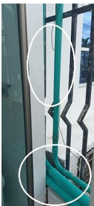
Foto No 7: Tuberías a la vista en PVC.
