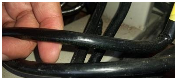
Foto No 4: Conductores No 4 AWG de acometidas eléctricas a pisos sin especificaciones de bajo contenido de halógenos.
