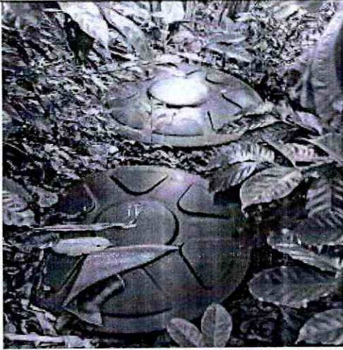
3. Sistema vivienda 1 y 2 fuera de funcionamiento
