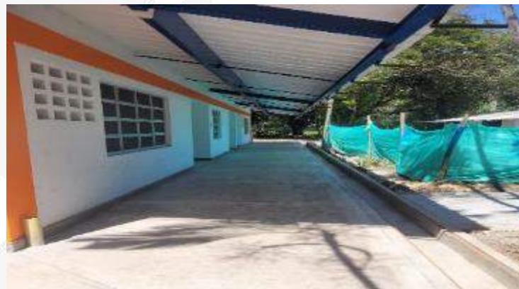
PENDIENTE INSTALACION DE CANAL PERIMETRAL Y REJILLAS CARCAMO
