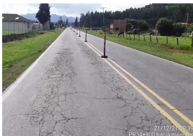
PR34+900 CARRIL DERECHO ESTADO INICIAL RODADURA UBATE - CHIQUINQUIRA
