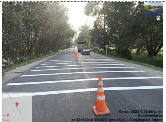
PR33+0300 RUTA 45A05 LÍNEAS REDUCTORAS DE VELOCIDAD
