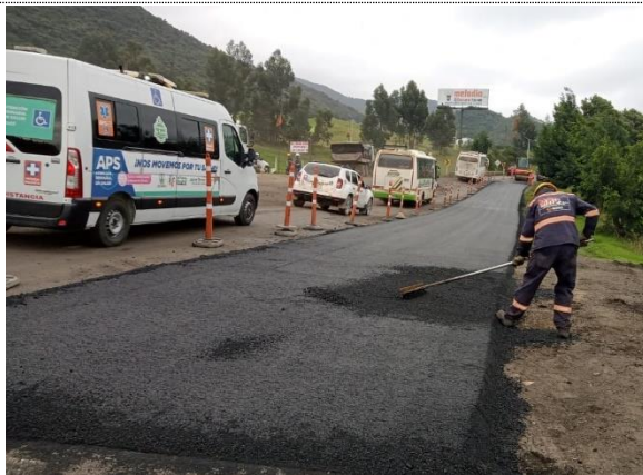
RUTA 45 A 04 RENIVELACIÓN CON MEZCLA ASFÁLTICA ASENTAMIENTO DEL PR44+0300
