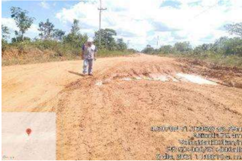
FOTO 1. Inspección fallos del PR50+000 hacia el PR60+000
