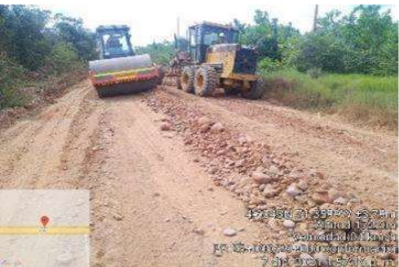
FOTO 5. : Podemos evidenciar la compactación del material conformado sin humectación.
