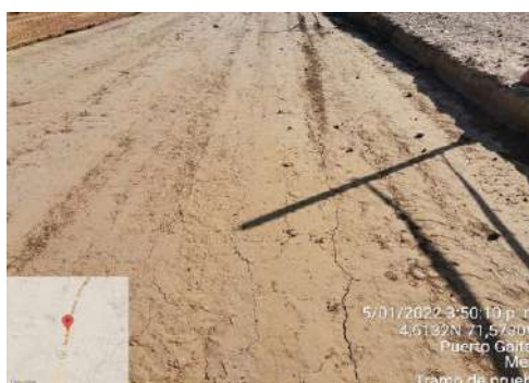
FOTO 5. : Inspección visual, aparición de grietas en un sector de los tramos de prueba.
