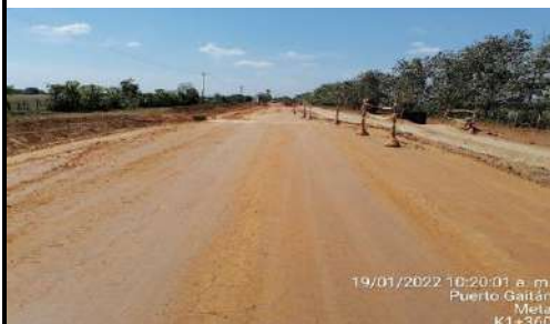
FOTO 6. K1+360 se evidencian fisuras en la segunda capa de terraplen
