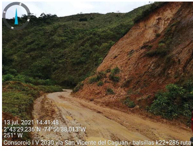
Fotografía 20. PR22+286 Flujo de lodos Talud Derecho Ruta 3002
