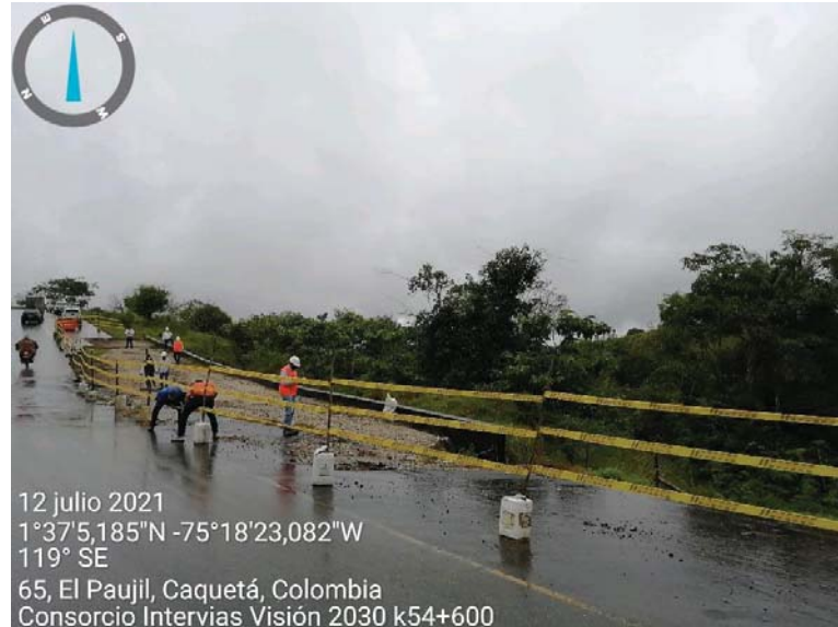
Fotografía 3 PR54+600 Perdida de Banca Carril Derecho Paujil, Caquetá
