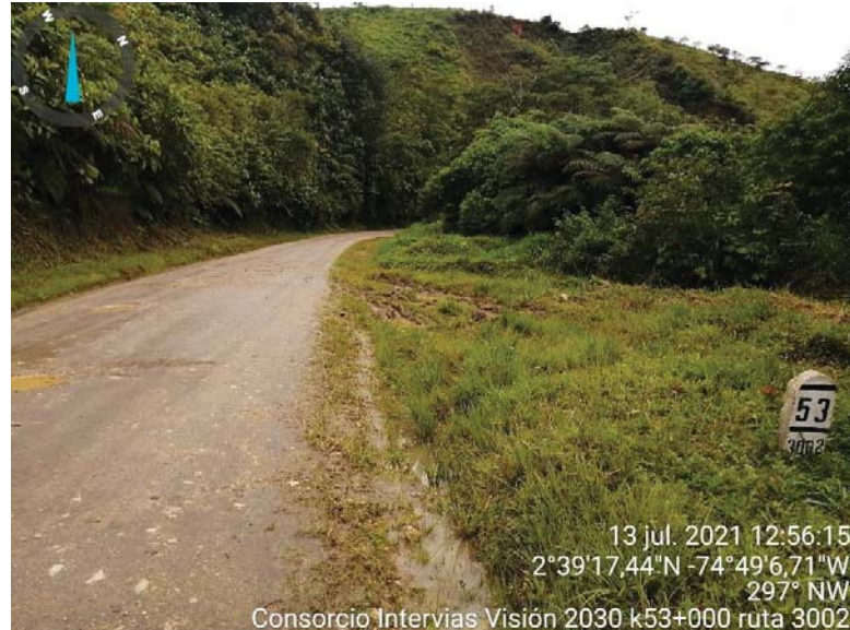
Fotografía 17. PR53+000 Vía San Vicente del Caguán - Mina Blanca Ruta 3002
