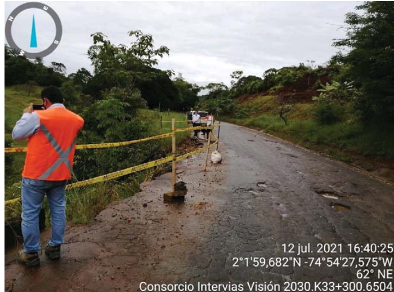
Fotografía 9. PR33+300 Perdida de Banca Carril Izquierdo Ruta 6504
