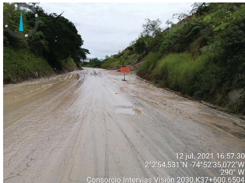
Fotografía 10. PR37+600 Flujo de lodos Talud Derecho Ruta 6504
