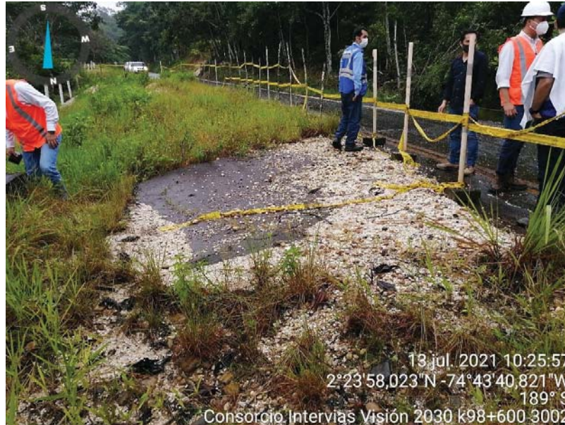
Fotografía 13.PR98+600 Perdida de Banca Carril Derecho Ruta3002
