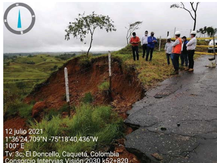
Fotografía 2 PR52+820 Perdida de Banca Costado Derecho Doncello- Caquetá
