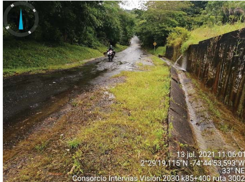
Fotografía 15. PR85+400 Falla Muro de Contención Costado Izquierdo
