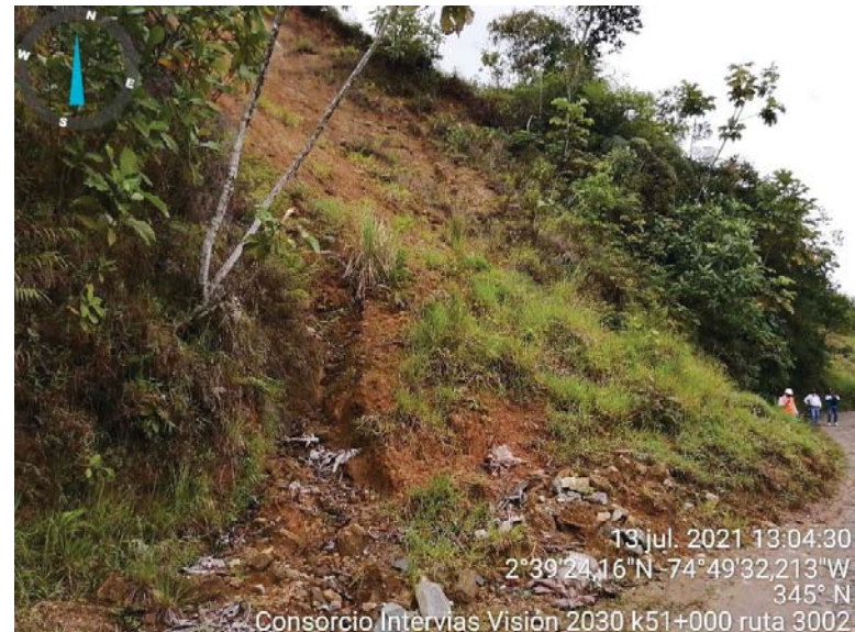
Fotografía 18. PR51+000 Deslizamiento Carril Derecho Ruta 3002
