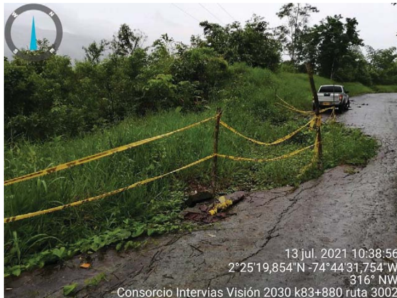
Fotografía 14. PR83+880 Perdida de banca carril derecho Ruta 3002
