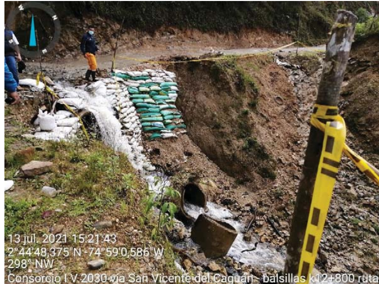
Fotografía 21. PR12+800 Daño total de la estructura de drenaje Ruta 3002
