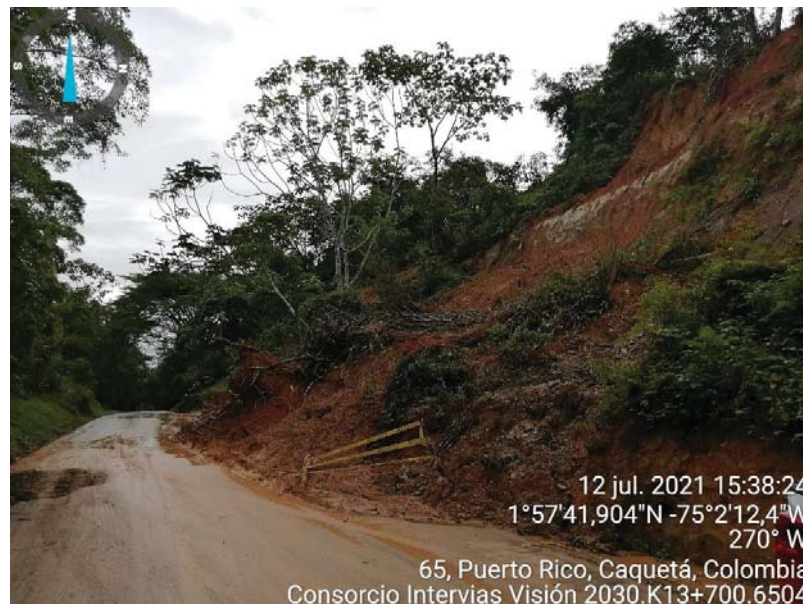
Fotografía 8 PR13+700 Deslizamiento Talud Derecho Puerto rico Caquetá Ruta 6504
