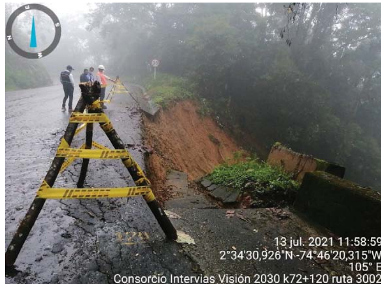
Fotografía 16. PR72+1210 Perdida de Banca Carril Derecho Ruta 3002
