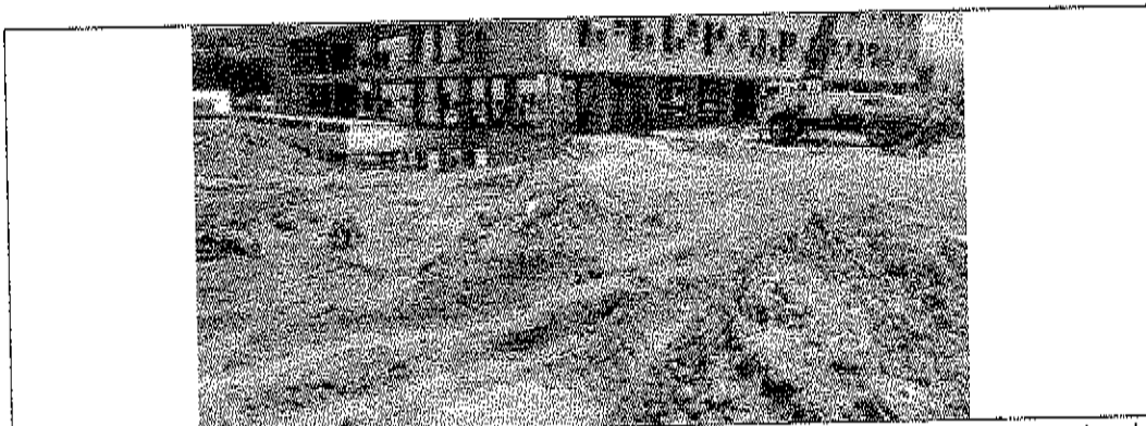
Imagen. Requerimiento de evacuación de escombros y /O acopio al sitio autorizado (foto tomada 14 de julio de 2022, 7:50 pm. Instalaciones ESEVI- Tunja.
