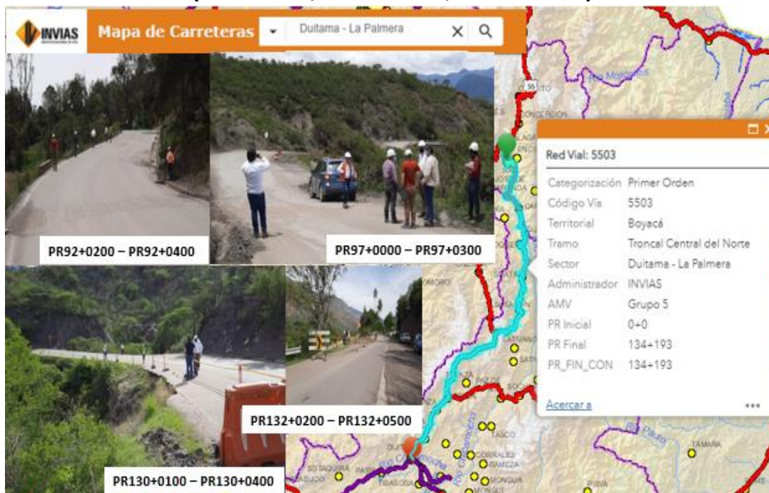
Imagen 6. Estado inicial de la Ruta 5503.
