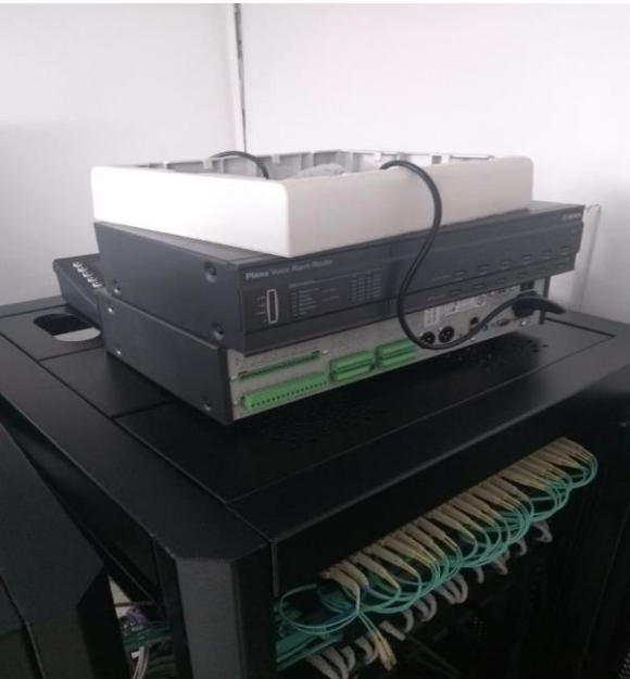
Sistema Plena de Alarma por Voz
