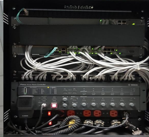
Rack de Piso
