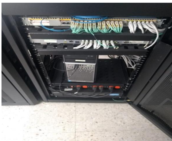
Rack de Datos Patch Panel Fibra
