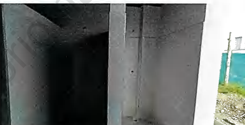
Duchas habitación 7 E1 - Piso 1
