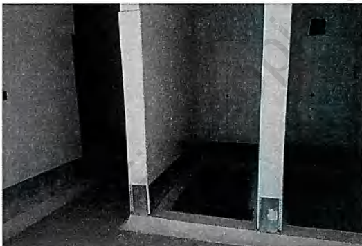
Baterías de Baños Hombres
