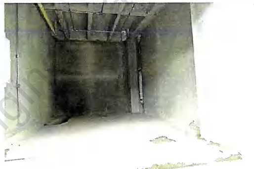
Espacio 2 de la subestación eléctrica
