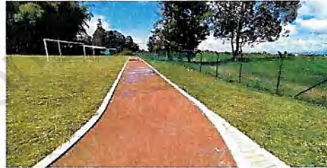
Se observa empozamiento de agua en pista de trote.
