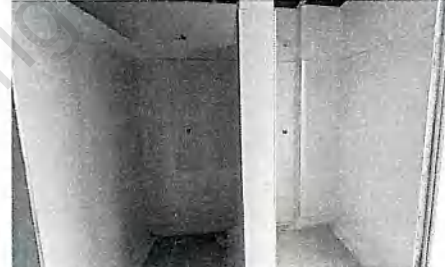
Duchas habitación 4 E1 - Piso 2
