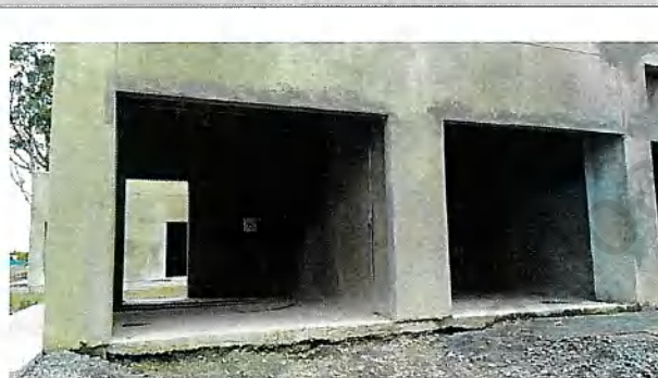
Sub estación eléctrica Bloque 5
