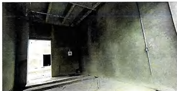
Espacio 1 de la subestación eléctrica
