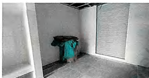
Vestíter habitación 5 E1 - Piso 1
