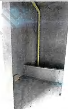
Cuarto de aseo UTB
